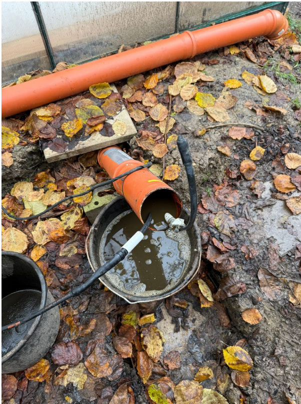
Abbildung 7: Heizkabel am Substrataustrag
