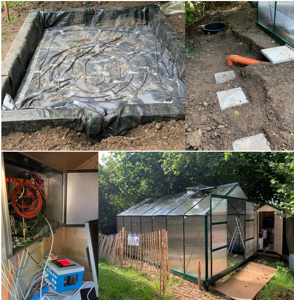
Abbildung 5: Zweiter Aufbau Mikro-Biogasanlage
