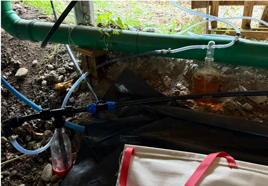
Abbildung 8: Installierte Druckregulierung und zweite Wassertasse
