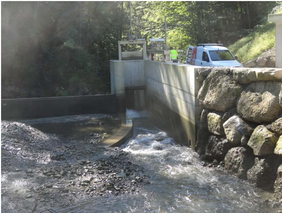
Abbildung 5: Geöffnete Spülschütze vom Oberwasser bei abgesenktem Stauspiegel, kein KW-Betrieb
