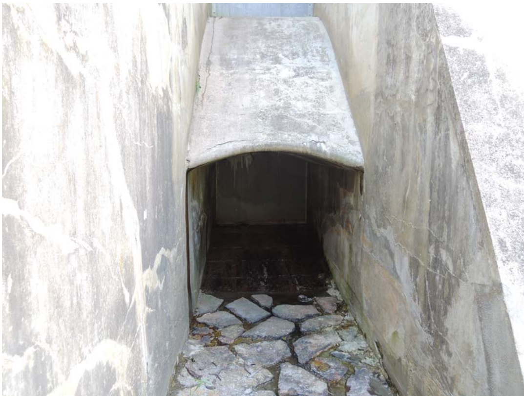
Abbildung 6: Spülöffnung mit Spülschütze am rechtsseitigen Bachufer
