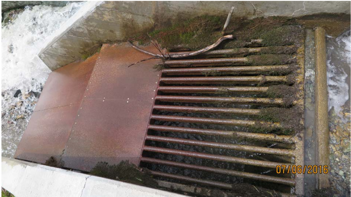
Abbildung 3: Detail Hauptfassung Prascherbach: Tirolerwehr und Schutzblech
