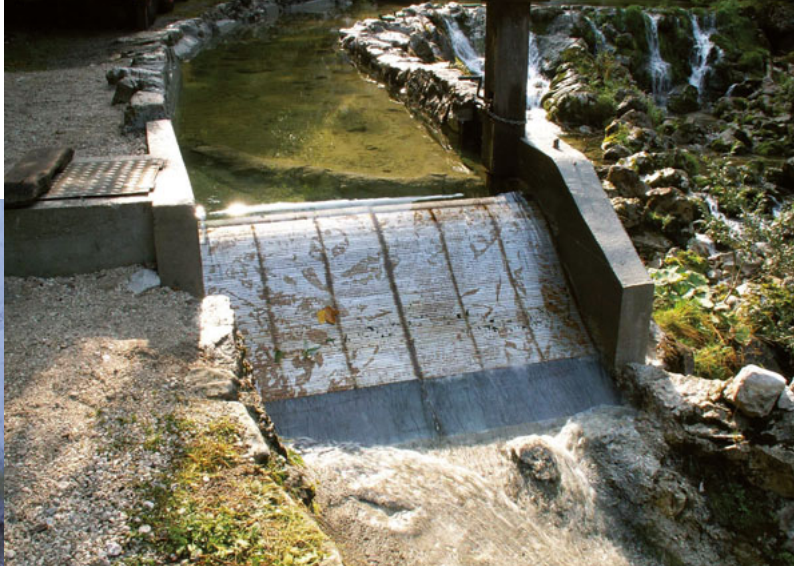
Coanda-Rechen im Betrieb.
