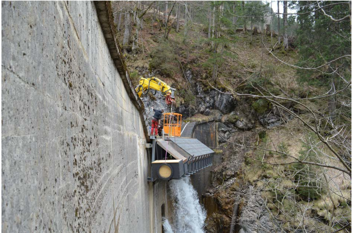
Abbildung 1: Seitenansicht mit der an die Wildbachsperre angehängte Stahlkonstruktion
