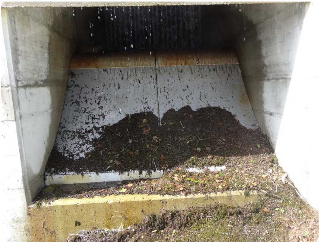
Abbildung 4: Stark belegter Coanda-Rechen
