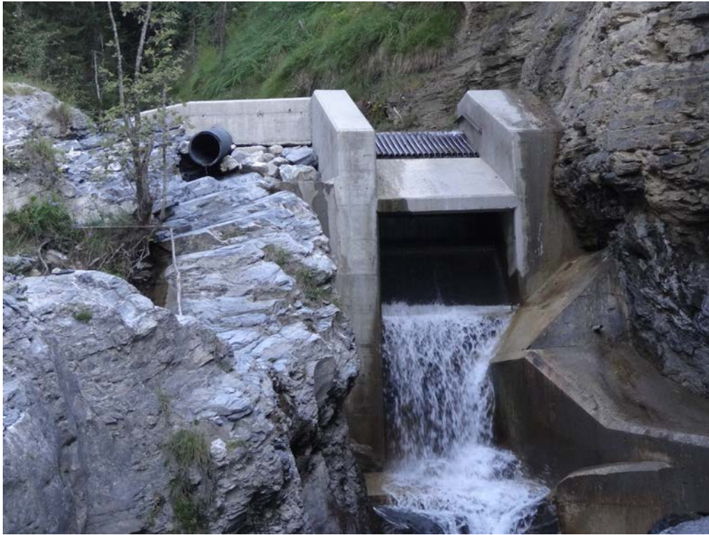
Abbildung 5: Versetzter, unten liegender Coanda Rechen im Schatten
