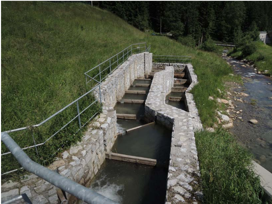
Abbildung 7: Fischtreppe (Beckenpass) am linken Bachufer
