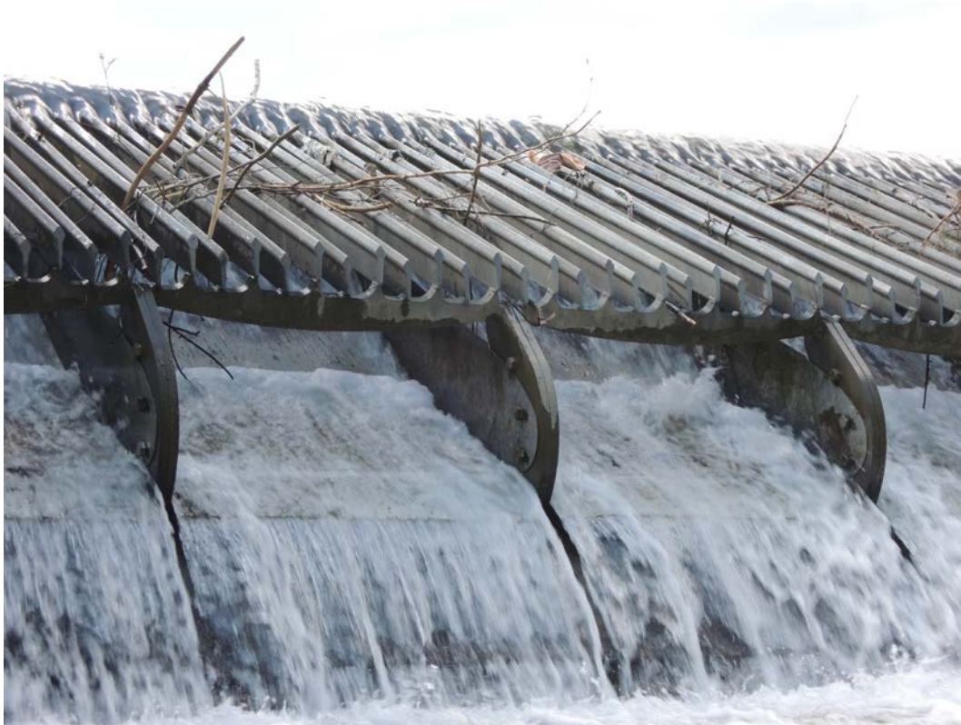
Abbildung 5: Detailansicht Schutzrechen und darunter sichtbarem Coanda-Rechen
