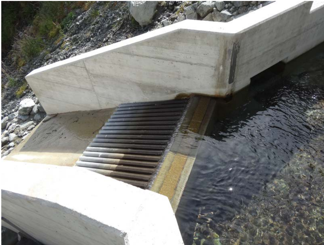
Abbildung 5: Grobrechen (Eigenkonstruktion), rechts Einlauf Spülschütze
