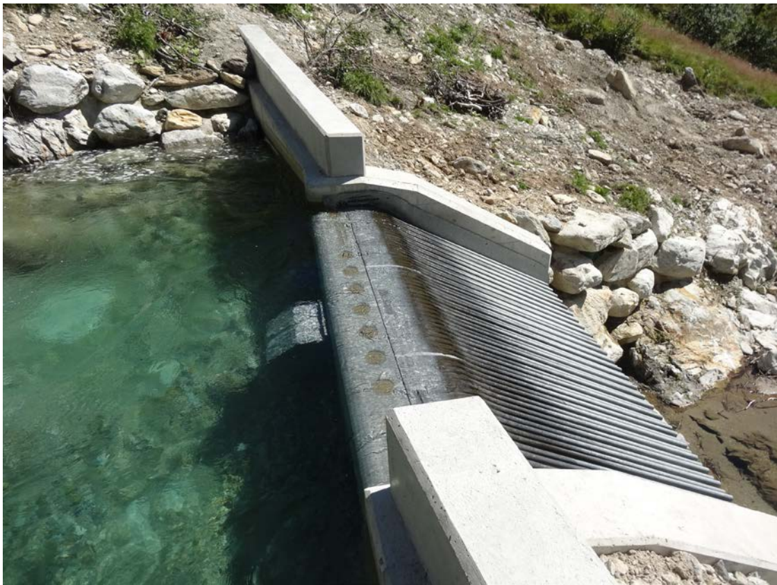
Abbildung 4: Detail Coanda-Rechen mit Grobrechen, Typ Grizzly Protec. In Wehrmitte Einlauf für Fassung bei Niederwasser
