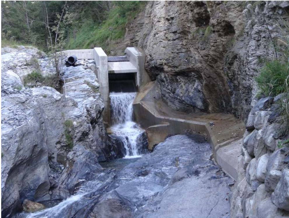
Abbildung 3: Sicht vom Unterwasser. Schutzrechen (oben), Conda-Rechen (unten), Spülrohr (links), Wasserableitung im betonierten Kanal (rechts)
