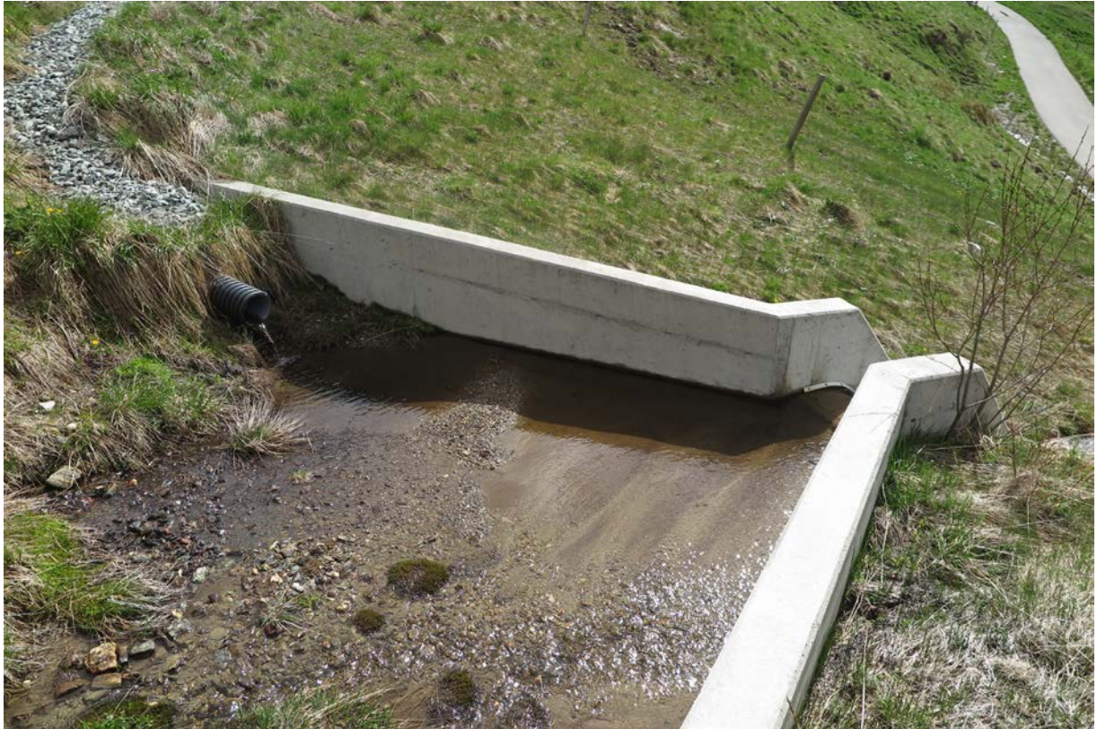
Abbildung 9: Fassung Prascherbach, Beispiel für Sammelbecken vor Coanda, sämtliche kleinen Fassungen sind ähnlich ausgestaltet
