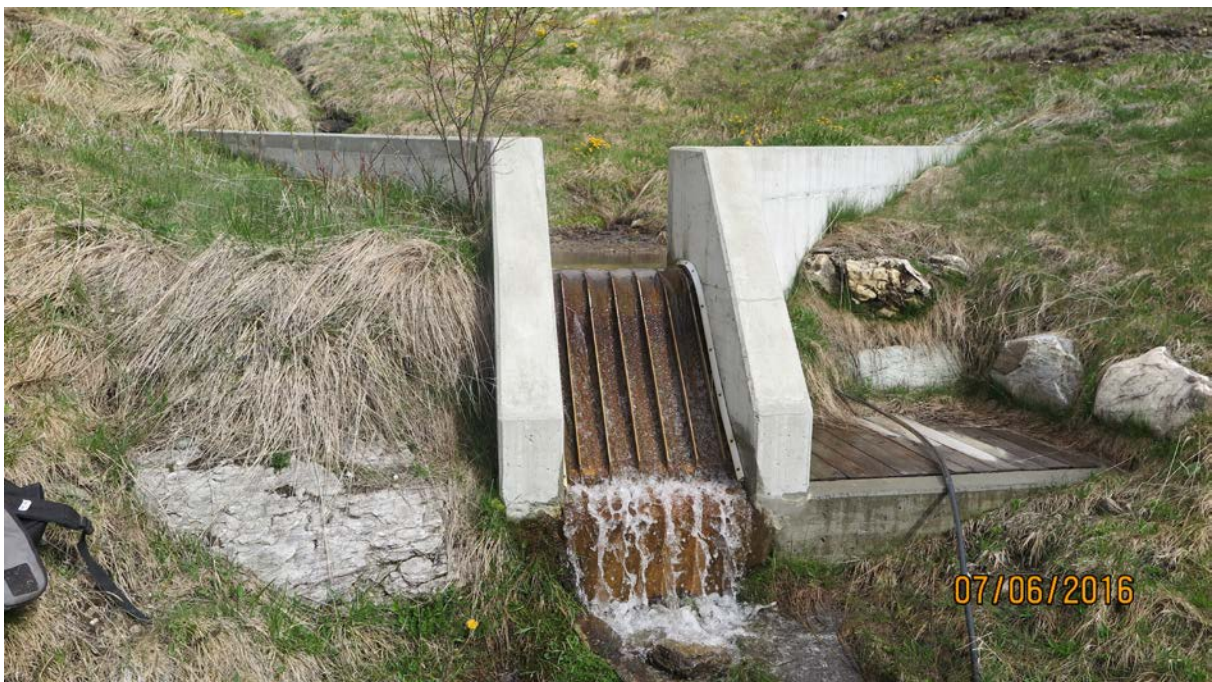
Abbildung 6: Übersicht 2. Fassung Hoflibach, sämtliche kleinen Fassungen sind ähnlich ausgestaltet
