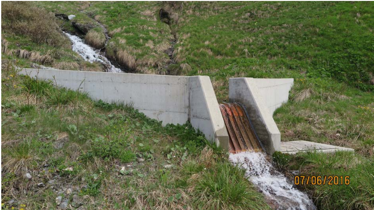
Abbildung 5: Übersicht Fassung Hoflibach, sämtliche kleinen Fassungen sind ähnlich ausgestaltet
