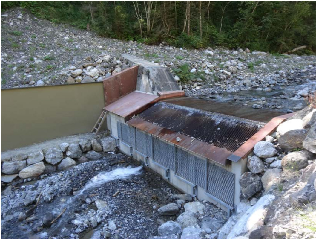
Abbildung 5: Seitenansicht mit Tirolerwehr als Grobrechen
