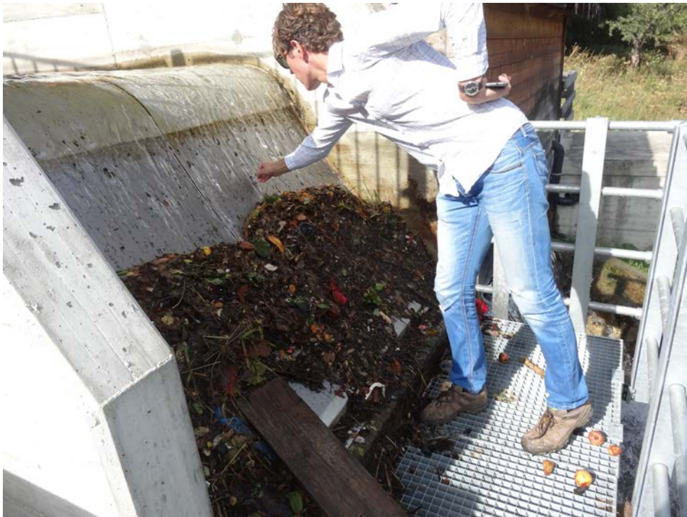
Abbildung 4: Stark belegter Coanda-Rechen. Das Stahlpodest behindert die Selbstreinigung des Rechen.
