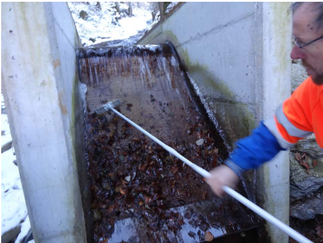
Abbildung 6: Rechen-Belegung mit Laub und leichte Vereisung der Betonwände
