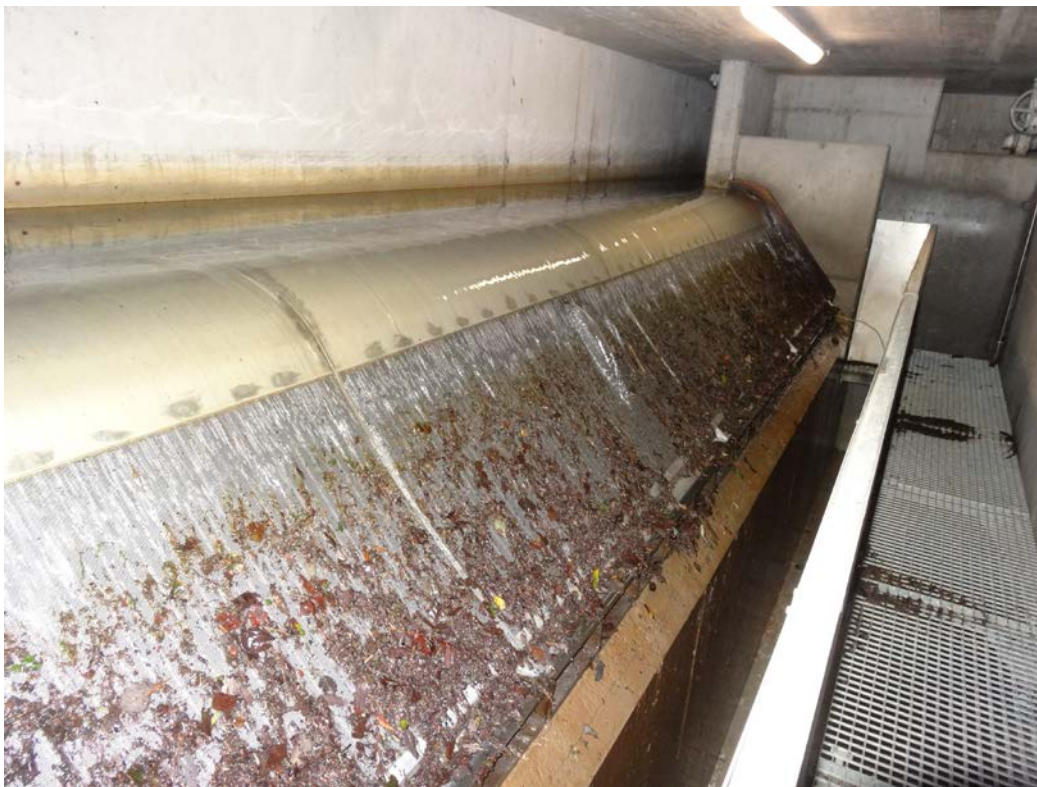
Abbildung 4: Coanda-Rechen mit Laub belegt, Verteilkanal (= Spülkanal) parallel zum Coanda-Rechen
