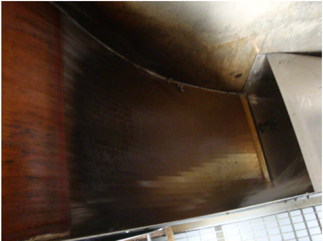
Abbildung 7: Coanda-Rechen im Gebäude-Innern (Bild: Repower AG)
