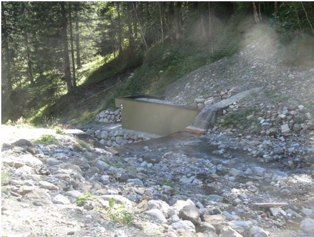
Abbildung 2: Sicht vom Oberwasser. Fassung in bestehende Wildbachsperre integriert
