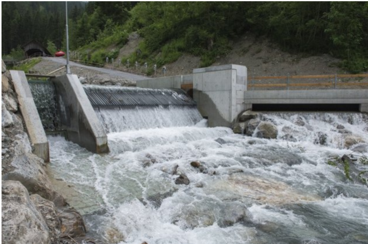
Abbildung 2: Übersicht Unterwasser: Links Spülkanal, Mitte Coanda-Rechen, rechts Sandfang
