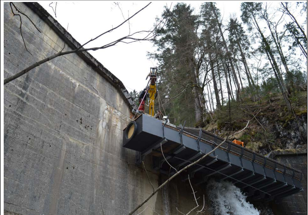
Abbildung 3: Sicht vom Unterwasser auf Wildbachsperre mit Stahlkonstruktion und Coanda-Rechen
