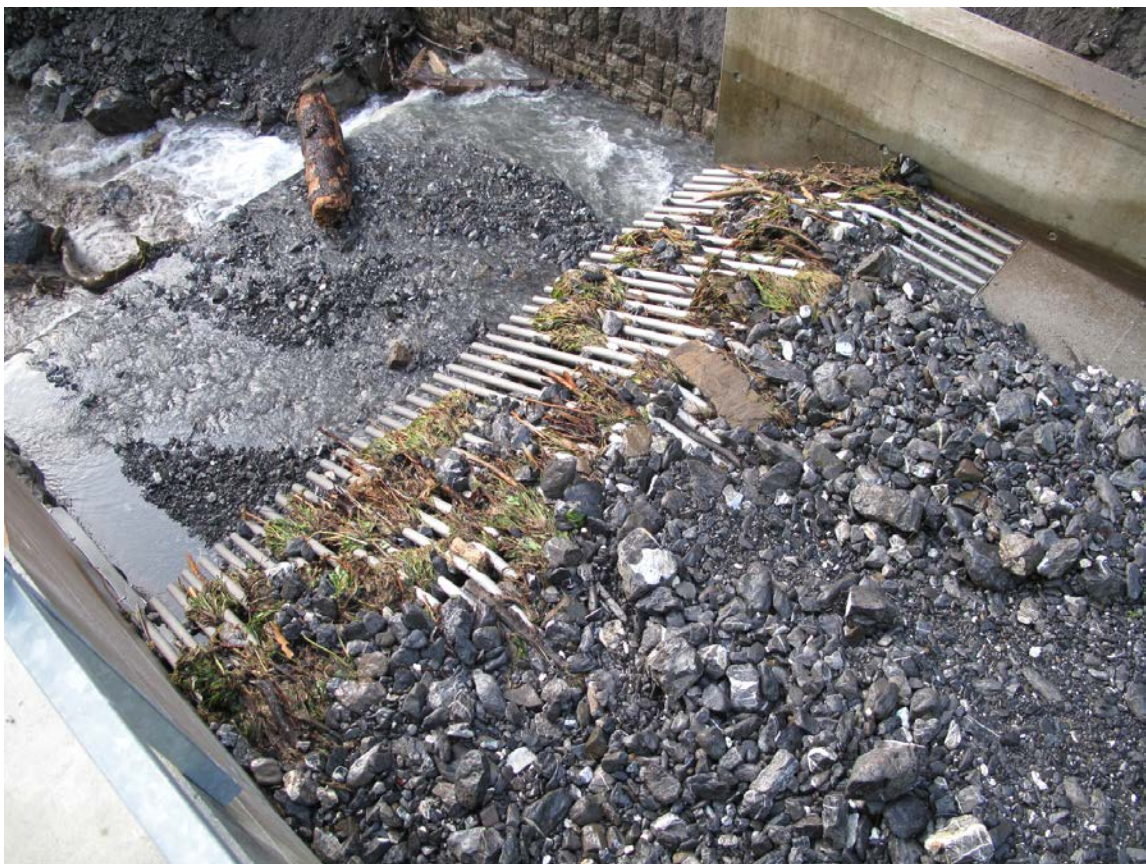
Abbildung 6: Starker Geschiebetrieb bei Hochwasser (Bild: EW Buchs)
