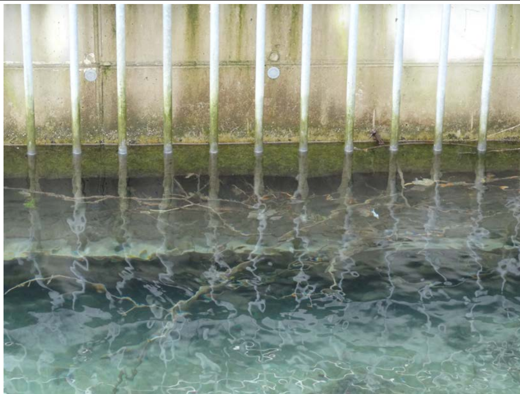
Abbildung 6: Detail der Tauchwand und Grobrechen mit senkrechten Stäben
