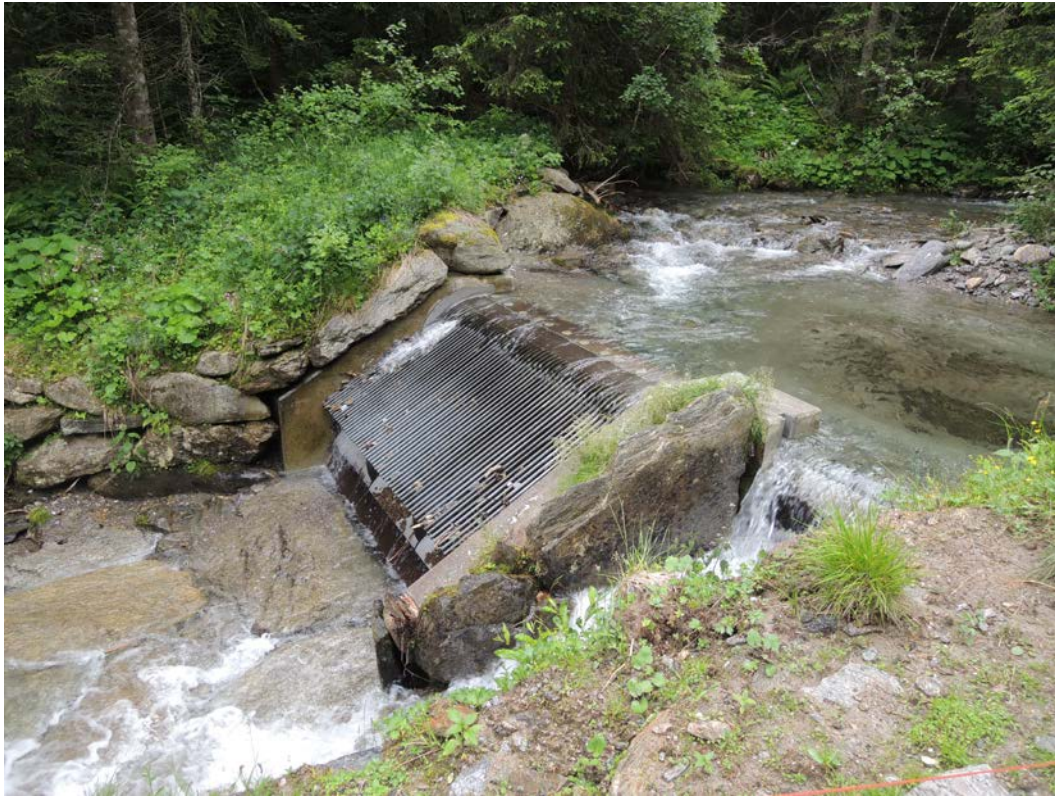
Abbildung 1: Übersicht der Anlage
