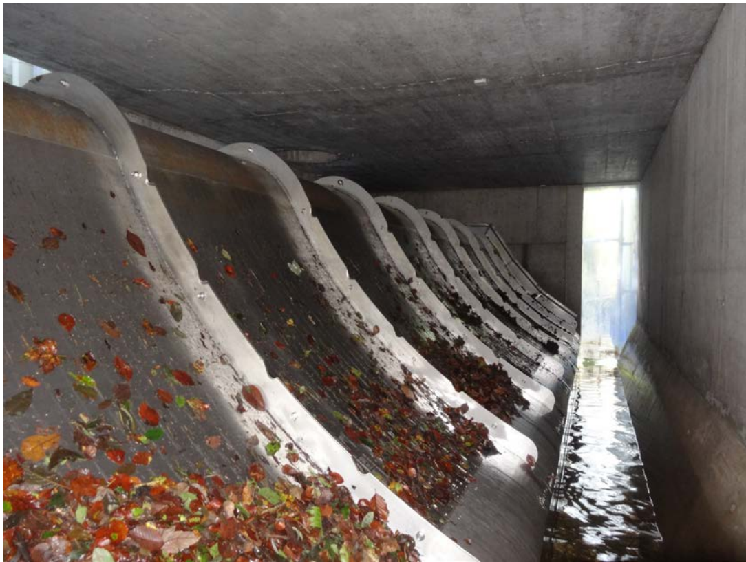
Abbildung 7: Detailansicht Coanda-Rechen mit grösseren Laubablagerungen, rechts Fischabstiegsrinne/Spülkanal. Kein KW-Betrieb
