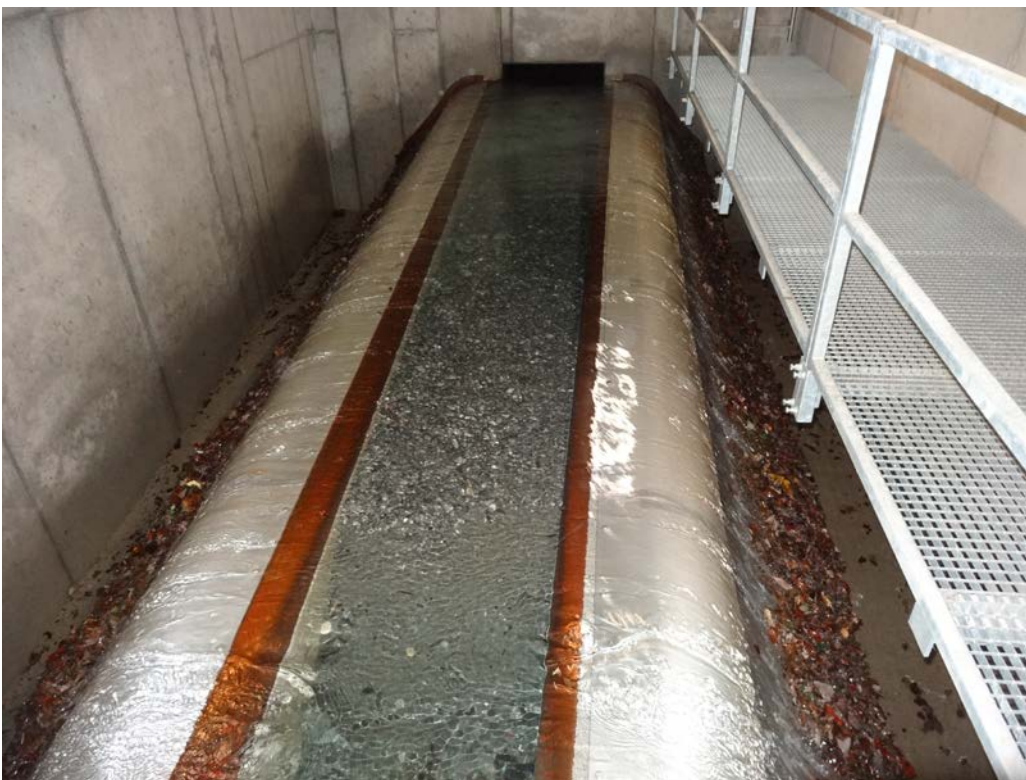
Abbildung 4: Beidseitig zum Verteilkanal (= Spülkanal) angeordneter Coanda-Rechen. Gut sichtbar sind die Geschiebeablagerungen im Spülkanal sowie die Belegung mit Laub
