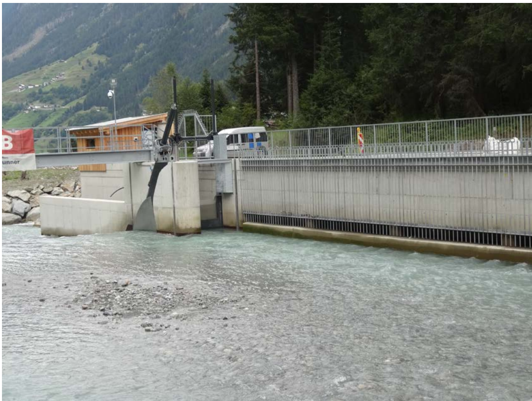
Abbildung 6: Seitenentnahme mit Grobrechen sowie Coanda-Rechen (nicht sichtbar) sowie Dotier-/Spülschütze bei abgesenktem Staupegel
