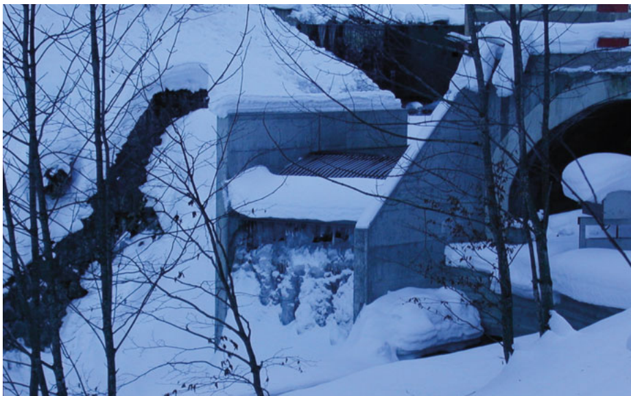
Coanda-Rechen am KW Tobelbach (EW Buchs), Buchs SG, Kapazität 150 l/s.
