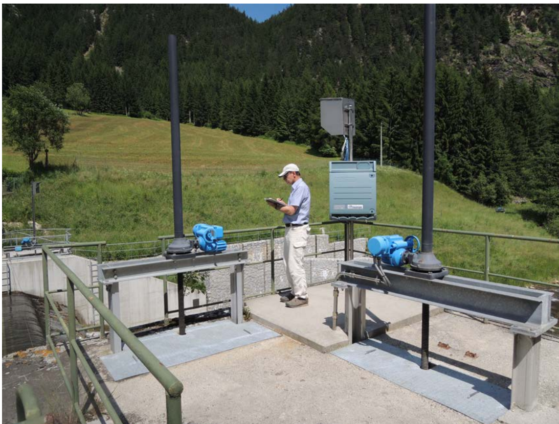
Abbildung 8: Motorisierte Spül- und Einlaufschütze am rechtsseitigen Bachufer
