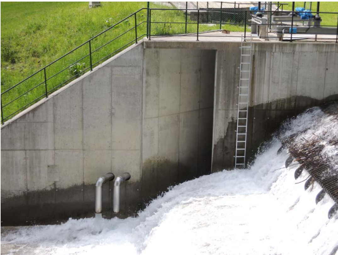
Abbildung 6: Mindest-Restwasserdotation mit Rohr auf rechter Bachseite. Zum Zeitpunkt der Aufnahme sehr viel Wehrüberfall
