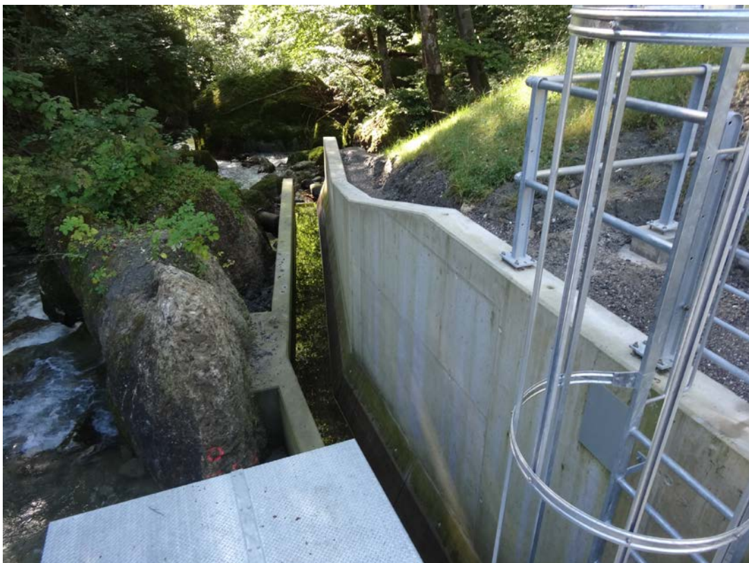
Abbildung 8: Ins Unterwasser verlängerte Fischabstiegsrinne/Spülkanal beim Coanda-Rechen. Rechts Einstiegsleiter zum Coanda-Rechen
