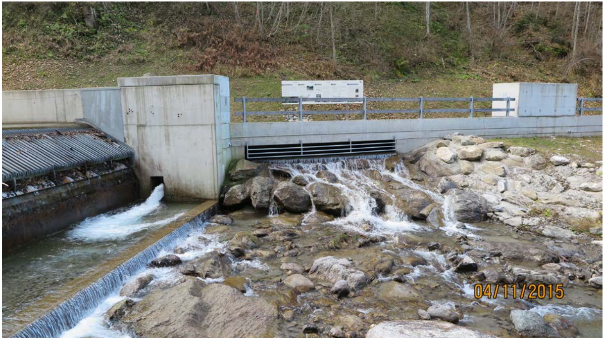
Abbildung 5: Coanda-Rechen (links), durch die Öffnung austretende Restwasserdotation sowie der Entsander mit Hochwasserüberlauf (Mitte)
