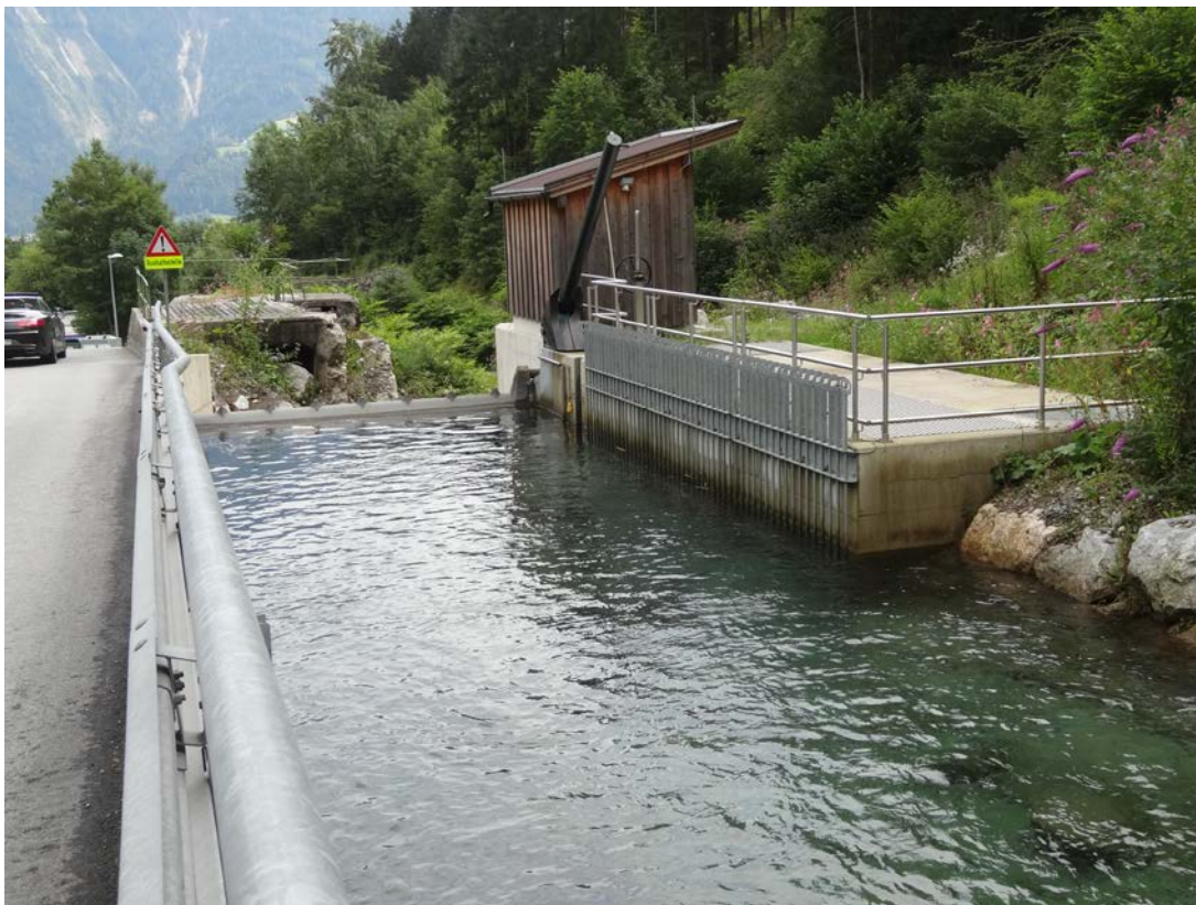
Abbildung 2: Blick vom Oberwasser. Seitenentnahme mit Coanda-Rechen rechts
