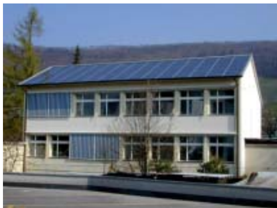
Fig. 15: Intégration en toiture, 12,75 kW c , à Wettingen (Photo: NET SA)
