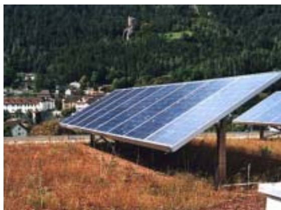
Fig. 14: Installation de 10 kW c pour toiture-jardin, système Solgreen, à Coire (Photo: NET SA)
