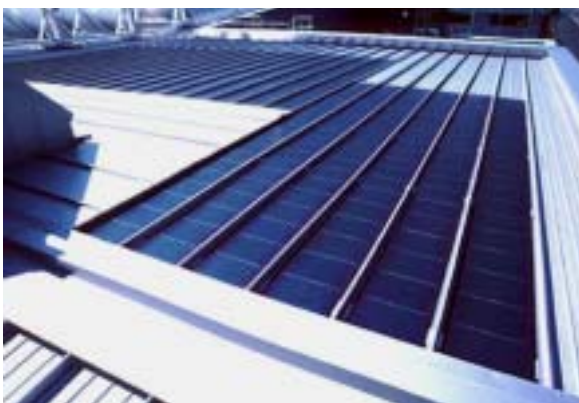
Fig. 19: "Euro-toiture" de 3 kW c PV amorphe, à Flums (SG) (Photo: NET SA)
