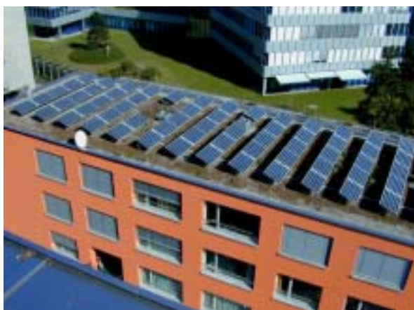
Fig. 21: Centrale PV Solgreen 1, à Zurich (Photo: NET AG)
