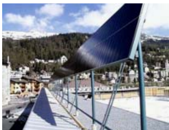
Fig. 16: Installation de 16,8 kW c à cellules CIS, à St-Moritz (Photo: LEEE-TISO)
