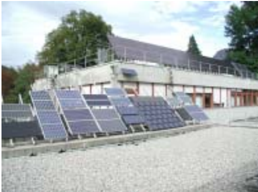
Fig. 5: Le banc d'essai pour modules PV du TISO (Photo LEEE TISO)
