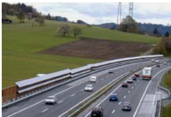
Fig. 20: Installation de 75 kW c sur les barrières anti-bruit de l'A1, à Safenwil (AG) (Photo: OFEN)
