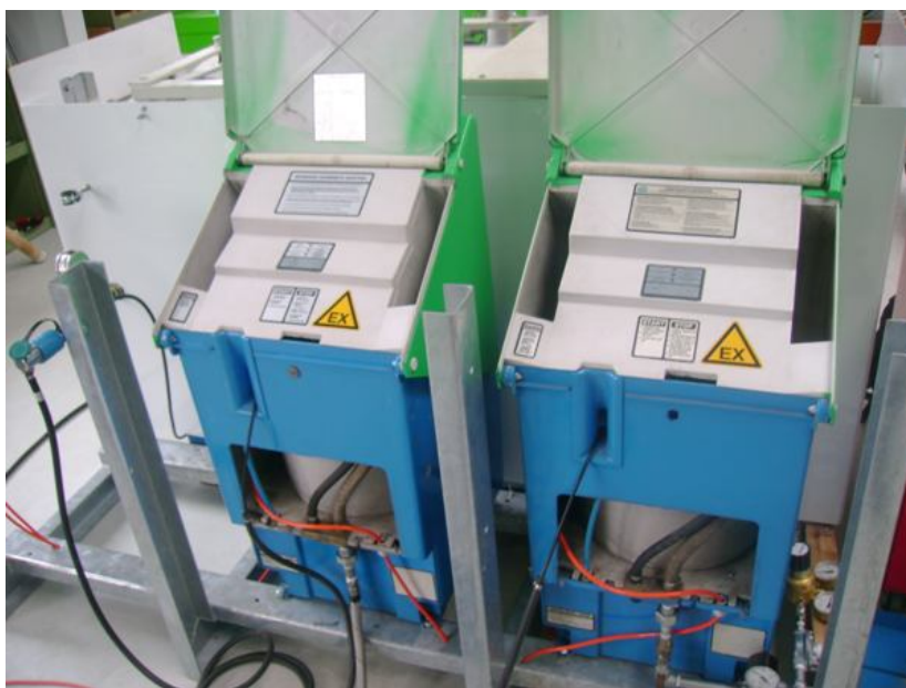
Abbildung 6: Biogasverdichter (links für Rohgas, rechts für das gereinigte Biogas)
