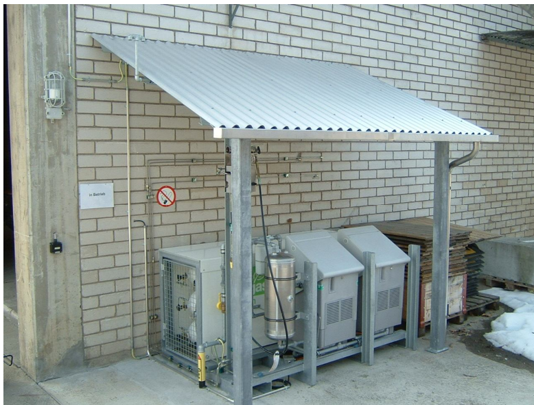
Abbildung 25: Synergie mit BONSAI-Erdgastankstelle mit vielen identischen Bauteilen
