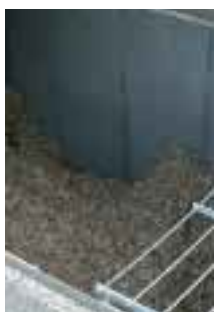
Le bois déchiqueté est stocké dans un silo souterrain.
