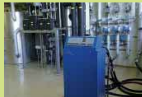
Le banc d'essai du Centre WPZ de Buchs (SG) pour les pompes à chaleur eau-eau et saumure-eau est utilisé depuis le début de l'année.
