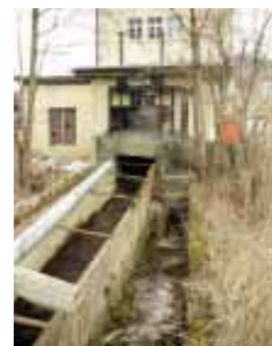
Zufluss durch den Oberwasserkanal zum Turbinenhaus, das unter Denkmalschutz steht.
