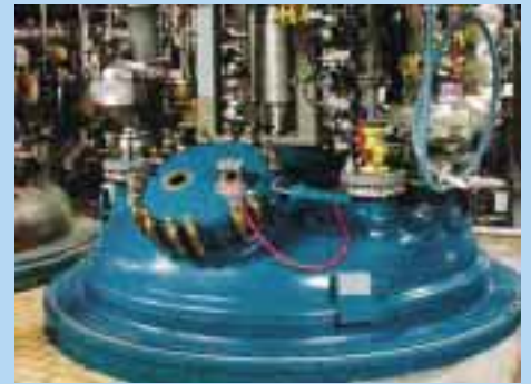
Typischer Reaktionskessel in einem Mehrprodukte- bzw. Mehrzweck-Batch-Betrieb.
