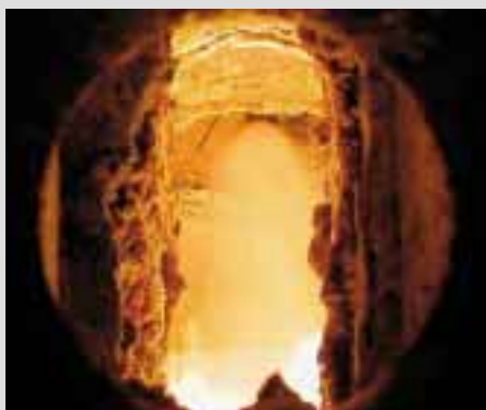
Brenner und Flamme in einer Verbrennungsanlage für Abfall-Lösungsmittel. (Foto: Valorec Services AG)
