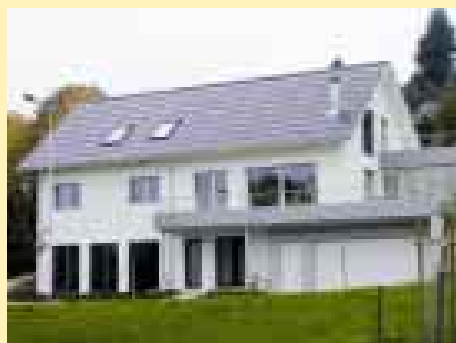
Auf der südlichen Dachhälfte des Hauses der Familie Erni in Unterschönenbuch wurde eine Solaranlage mit 11,7 kW p installiert. Die mit dem Solrif-System gerahmten Module sind überlappend montiert.
