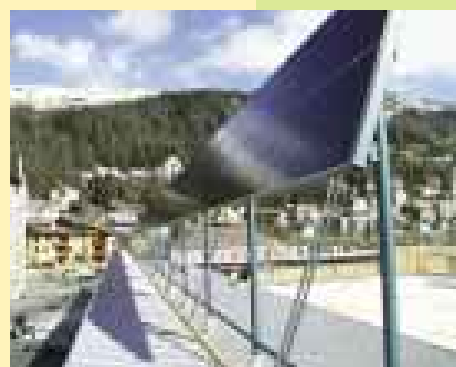
Die klimatischen und elektrischen Daten der CIS-Anlage in St. Moritz werden von TISO gemessen und ausgewertet.
