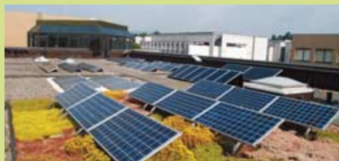
Demosite: Demonstration unterschiedlicher Integrationslösungen für Photovoltaik-Module, beispielsweise auf dem begrünten Flachdach.
