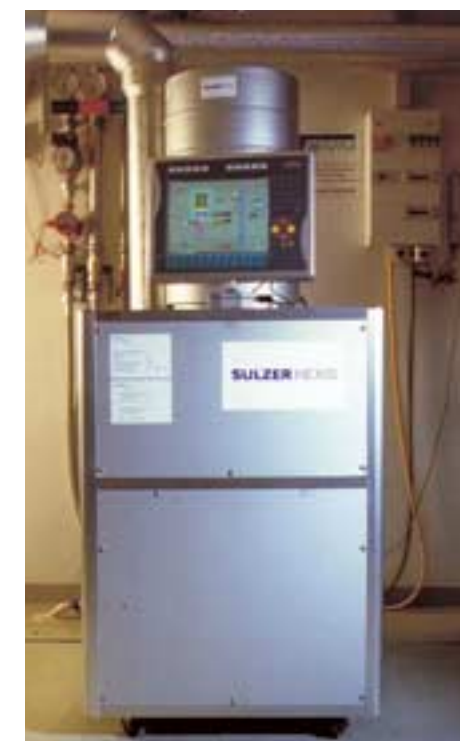
Das Hexis-Brennstoffzellensystem wurde während zwei Jahren in Feldtests geprüft. Mit sechs Anlagen wurden über 35'000 Betriebsstunden akkumuliert. (Foto: Sulzer Hexis AG)
