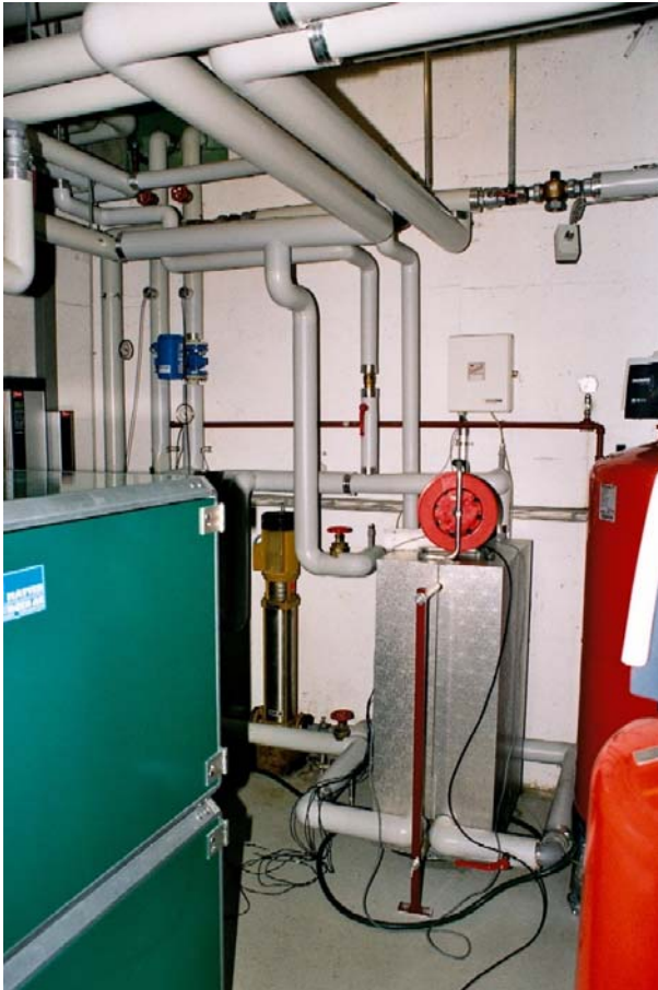
Figur 5: Die Umwälzpumpe und der Hauptwärmetauscher der ersten Ausbaustufe befindet sich zusammen mit der Messausrüstung im Keller der Kreuzstrasse 16.
