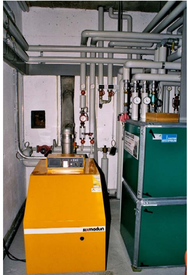
Figur 6: Redundanz-Heizkessel und die Wärmepumpen WP1 (oben) und WP2 (unten) ebenfalls im Keller der Kreuzstrasse 16.
