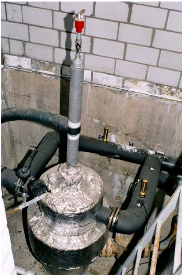
Figur 4: Der Bohrlochkopf innerhalb des Châlets mit den isolierten Verbindungsleitungen.
