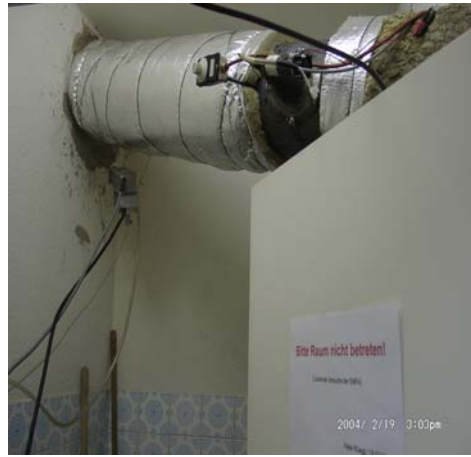
Abbildung 2 Provisorium an der Rauchgasleitung im Abstellraum mit SG02 (Quelle: Eigene Fotos)
