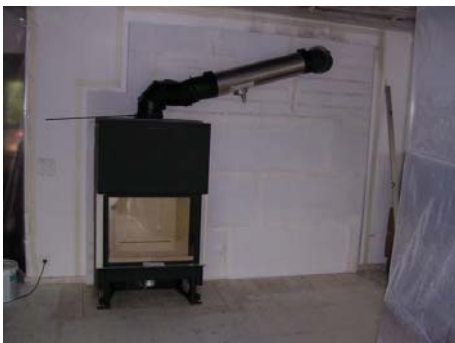
Abbildung 4 Aufbau Pilotanlage mit seitlich gezogenem Kamin. Der Filtereinsatz ist zur Konzeptbeurteilung unten befestigt. In der definitiven Ausführung ist die Position oben auf dem Abgasrohr (Quelle: Eigene Fotos)
