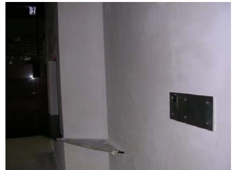
Abbildung 9 Neue Cheminéeanlage, im Vordergrund das eingeschobene Steuergerät. Bis zum Abschluss der Malerarbeiten noch mit einem provisorischem Frontpanel aus Aluminium. (Quelle: Eigene Fotos)
