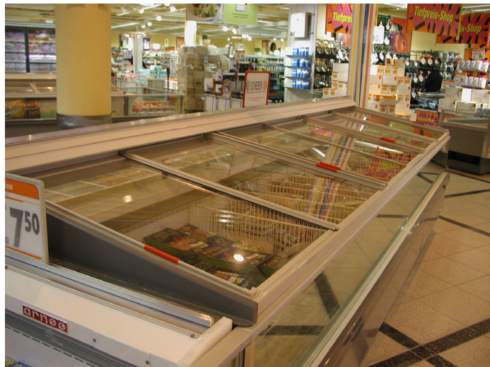
Abb: Kühlinsel, hier ein TK-Möbel mit Glasschiebeabdeckung
