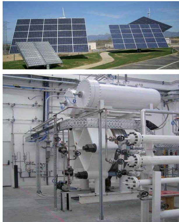
Figur 1: Alkalischer Elektrolyseur (50 kW) der Schweizer Firma IHT im spanischen Pilotprojekt IHER. Die Aktivitäten von IHT bilden einen zentralen Beitrag im Wasserstoff Implementing Agreement der Internationalen Energie Agentur (IEA) [ task24.hidrogenoaraqon.org ].
