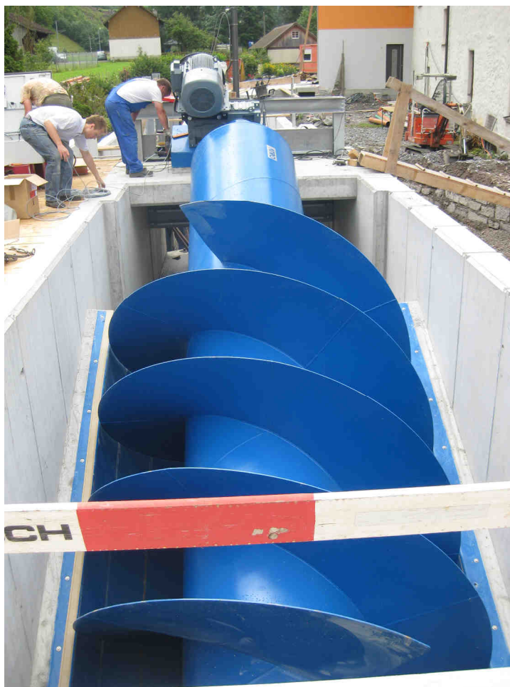
Fig. 6: Wasserkraftschnecke Ronner, Ennenda (Quelle: Ritz-Atro GmbH)
