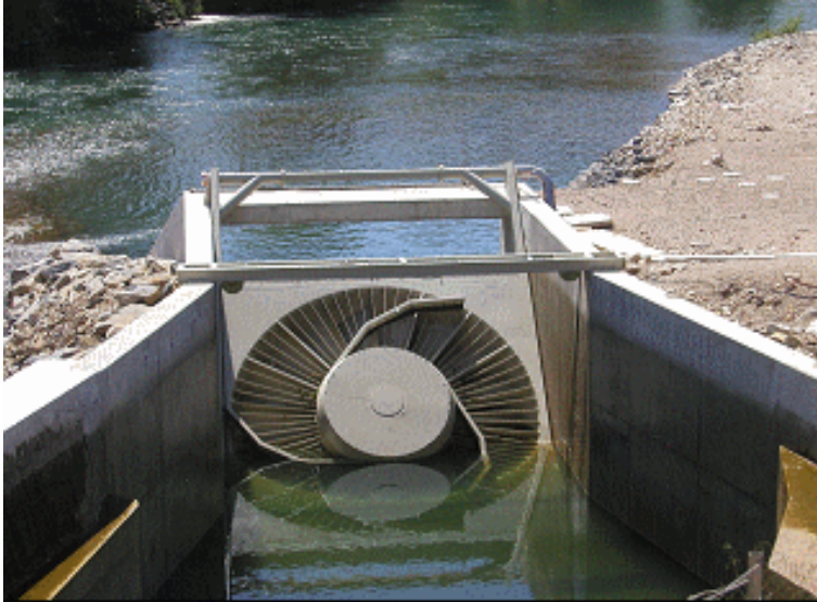
Fig. 7: VLH Turbine bei abgesenktem Oberwasserspiegel (Quelle: MJ2)
