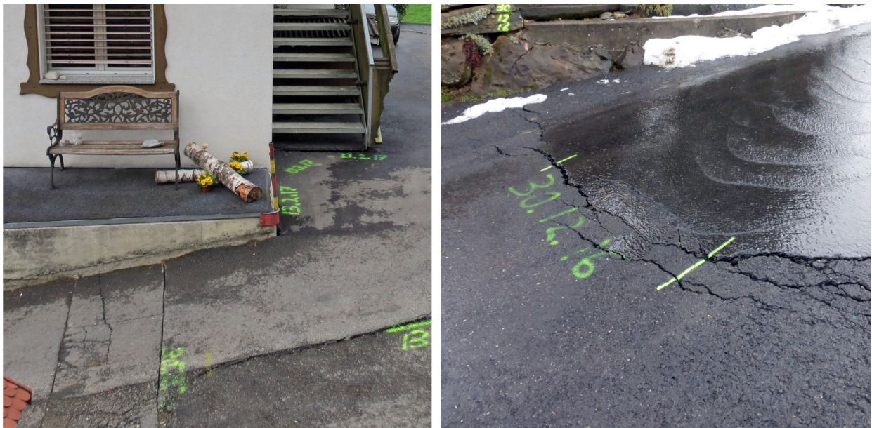
Figur 2: Frische Setzung des Geländes bei Gebäuden und Risse im Belag deuten auf aktive Rutschung hin
