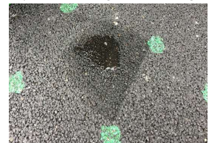
Bsp. Wasser im Belag bei LDK-Messung
