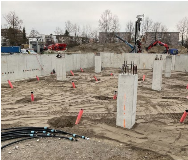
Abbildung 13: Erdsonden-Wärmespeicher der EMPA in Dübendorf.
