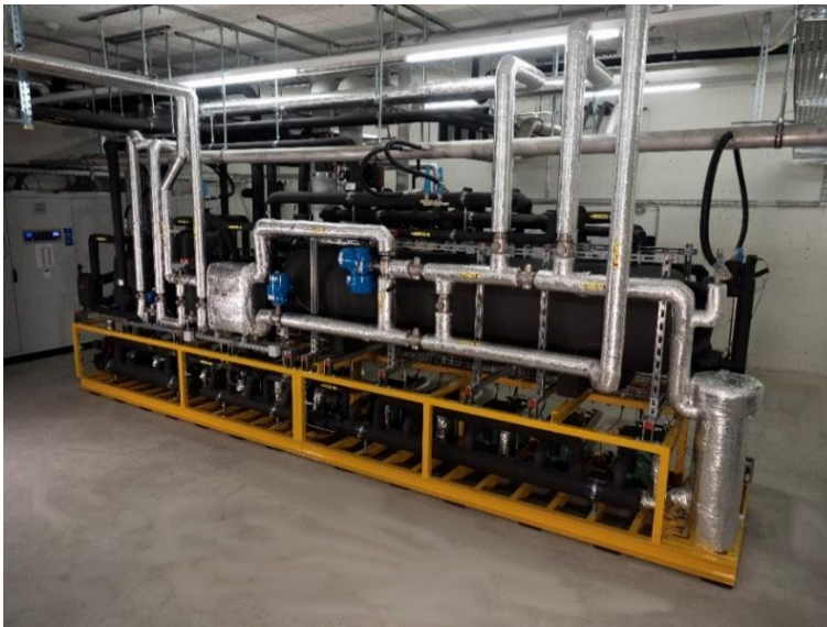
Abbildung 6: CO 2 -Booster Kälteanlage mit Abwärmenutzung, Ejektoren und Parallelverdichtung für Plus- und Minuskühlung nach dem heutigen Stand der Technik.
