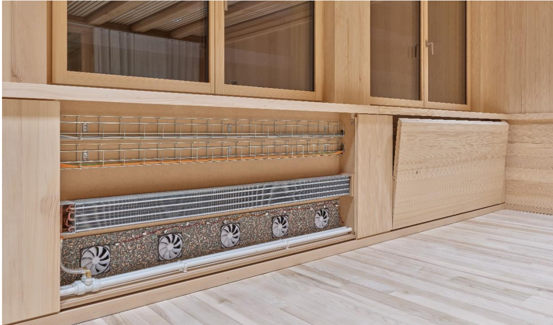
Abbildung 38: Installationsraum entlang Aussenwand Quelle: PIRMIN JUNG Schweiz AG
