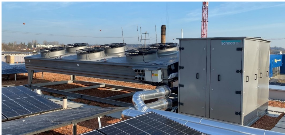
Abbildung 60 Auf dem Flachdach von Haus A aufgestellte Luft/Wasser-Wärmepumpe; Wärmeleistung (A-7/W35): 140 kW
