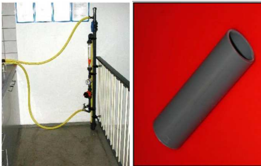
Abbildung 11 Rechts ist der generelle Aufbau der parallel durchflossenen Testleitungen (Aus Powerpointpräsentation «Untersuchung zu den Auswirkungen erhöhter Wassertemperaturen auf die mikrobiologische Situation bei der Trinkwasserverteilung – MibiTemp» von Dr. Andreas Korth, DVGW. Links sind die EPDM-Testrohrstücke, welche mit einem Durchfluss von ca. 20 L/h durchflossen wurden. Diese Rohrstücke wurden nach einem Jahr entnommen und auf Legionellen mit ddPCR untersucht.
