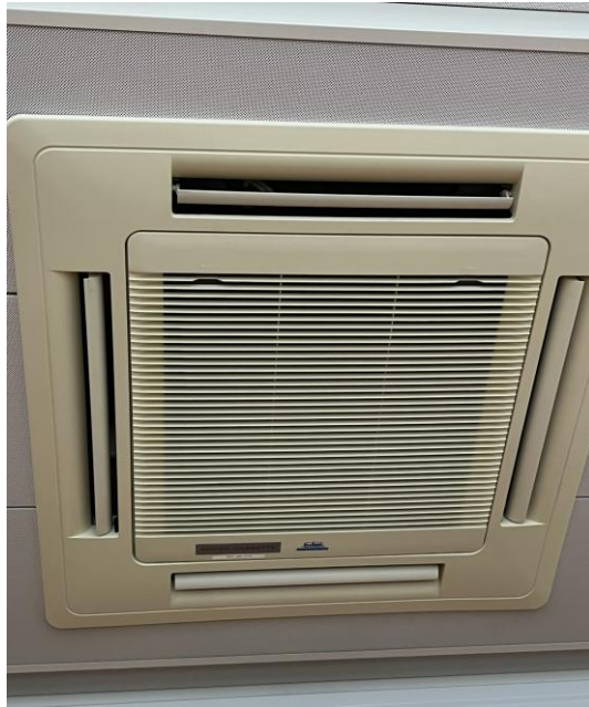
Abbildung 25: Umluftkühlgerät (ULK) in der abgehängten Decke.
