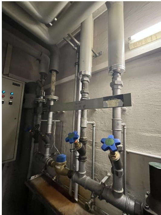
Abbildung 29: Sanitärverteiler mit Armaturen.
