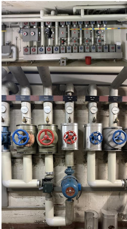
Abbildung 19: Heizverteiler im UG, Gebäudeteil C (D ist identisch).
