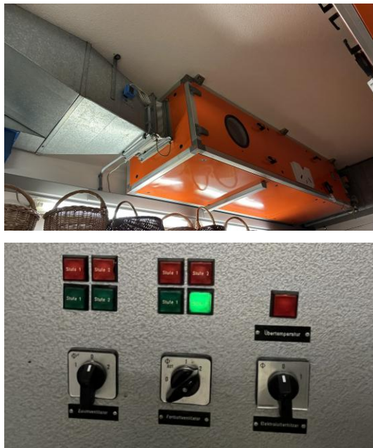
Abbildung 37: Mechanische Lüftung in der Küche.
