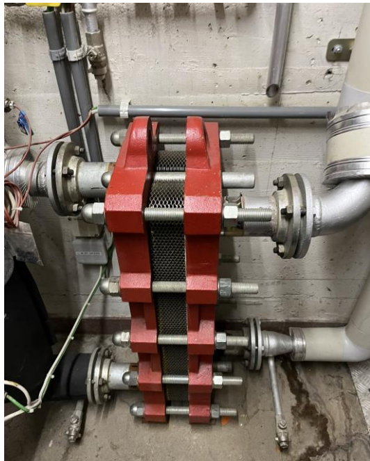
Abbildung 18: Plattenwärmetauscher für die Brauchwarmwasser.
