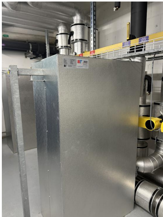
Abbildung 45: Übergabestation Fernkälte im 2. Untergeschoss.
