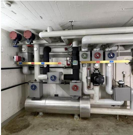
Abbildung 17: Wärmetaucher als Unterstation im UG, Gebäudeteil C (D ist identisch).
