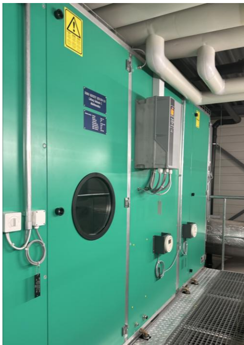
Abbildung 27: Neues Lüftungsgerät (Gebäude C) in der Dachzentrale.
