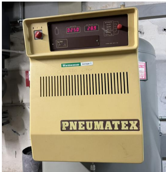
Abbildung 20: Alte Expansionsanlage im UG, Gebäudeteil D.
