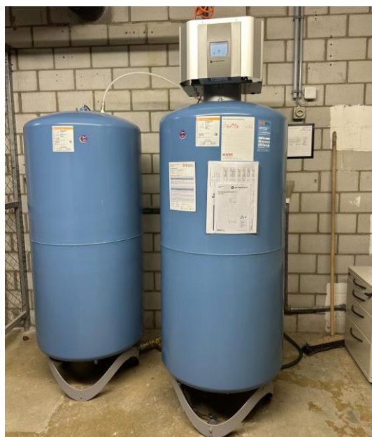
Abbildung 21: Neue Expansionsanlage im UG, Gebäudeteil C.
