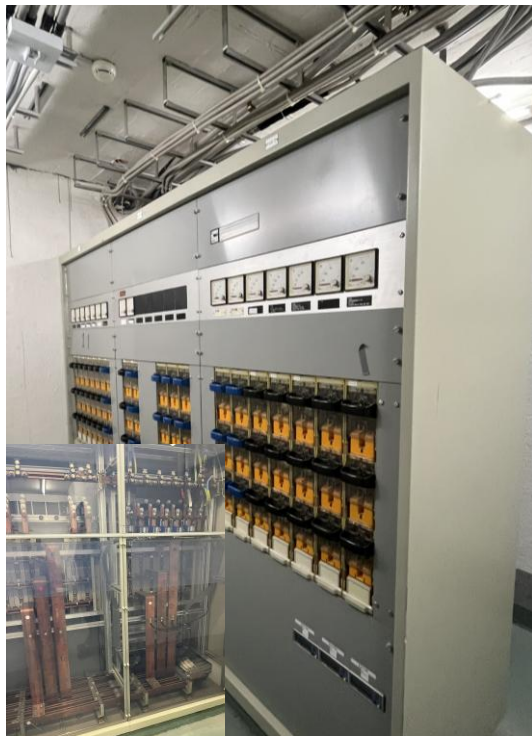
Abbildung 14: Alte Elektroverteilung im Untergeschoss.
