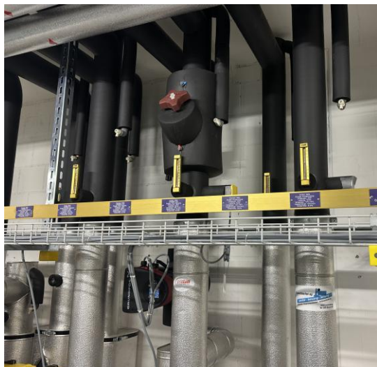
Abbildung 46: Kälteverteiler inkl. Pumpen und Armaturen.
