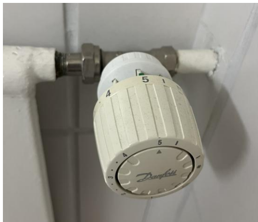
Abbildung 22: Heizkörper mit Thermostatventil.
