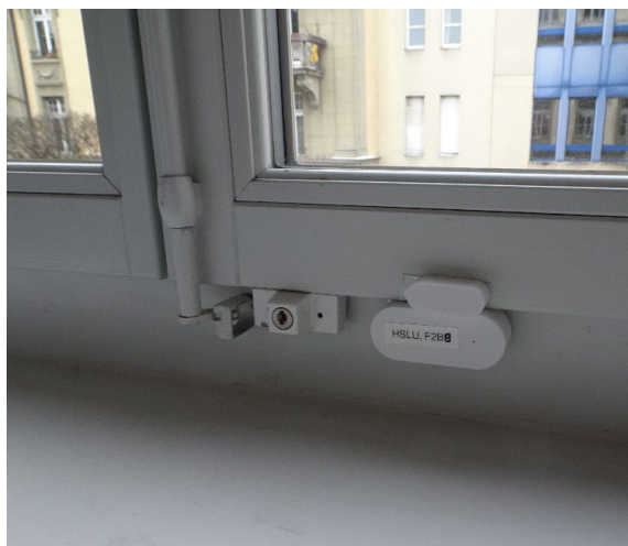
Abb. 6: Lora-Logger bei einem Fenster.
