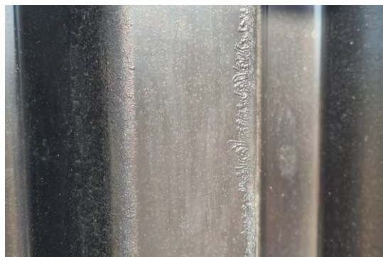
Figure 8 : Photo illustrant un cas de tôle avec de la rouille blanche © Montana
