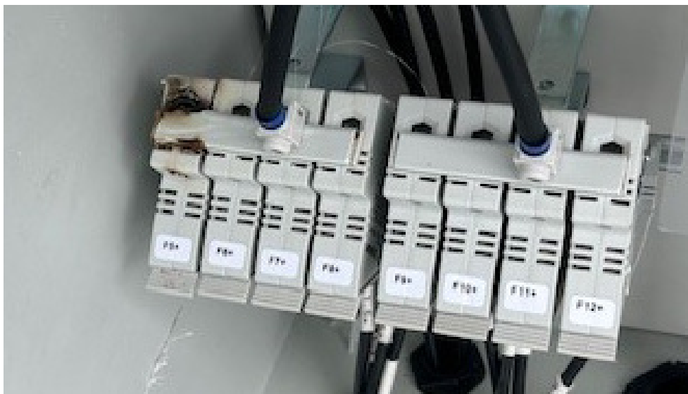
Abbildung 35 Durchgeschmorte Strangsicherung in GAK 1
