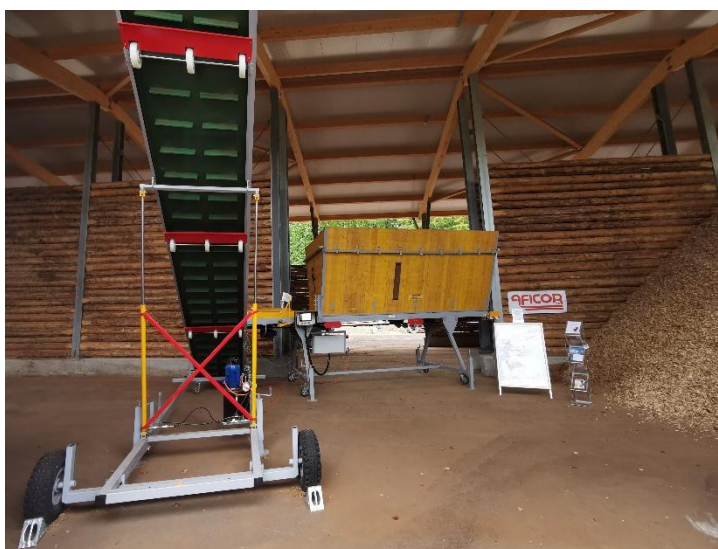
Figure 5 : Installation finale dans le hangar de Châtillon - Énergie Durable SA
