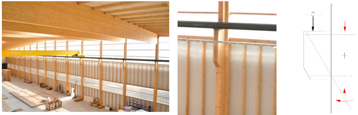
Abb. 1.2: Kranbahnträger aus Stahl aufliegend auf BSH-Konsolen, welche mittels eingeklebten Gewindestangen mit den BSH-Stützen verbunden sind. (Bild: neue Holzbau AG).
