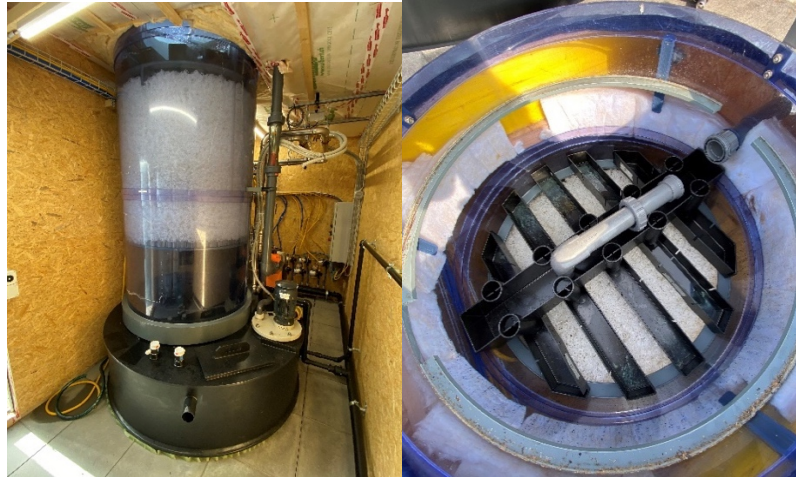
Figure 8: Desorber / Charger in the project “Gewächshausklimatisierung”.
