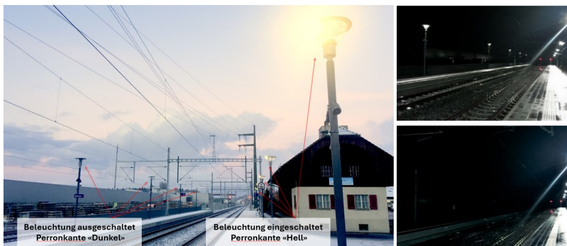
Das umgesetzte Konzept am Bahnhof Müntschemier umfasst die beiden Außenperrons. Es ist ersichtlich, dass die Kandelaber an der Perronkante von Gleis 2 ausgeschaltet sind, während die Kandelaber an der Perronkante von Gleis 1 eingeschaltet sind. In den beiden kleinen Bildern rechts wird der Unterschied zwischen einer voll beleuchteten Perronanlage auf Gleis 1 und 2 (oberes kleines Bild) und einer bedarfsgerecht beleuchteten Perronanlage (unteres kleines Bild) dargestellt.
