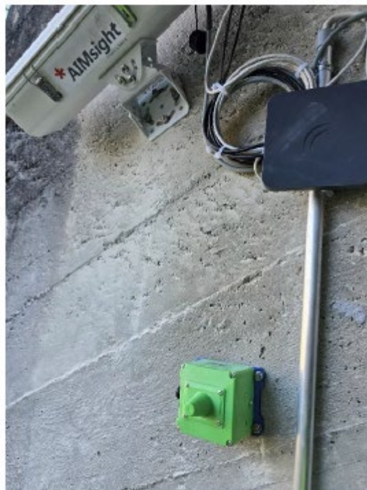
Figure 12 : Déploiement de la caméra AIMsight à la sellette 1, sous la passerelle
