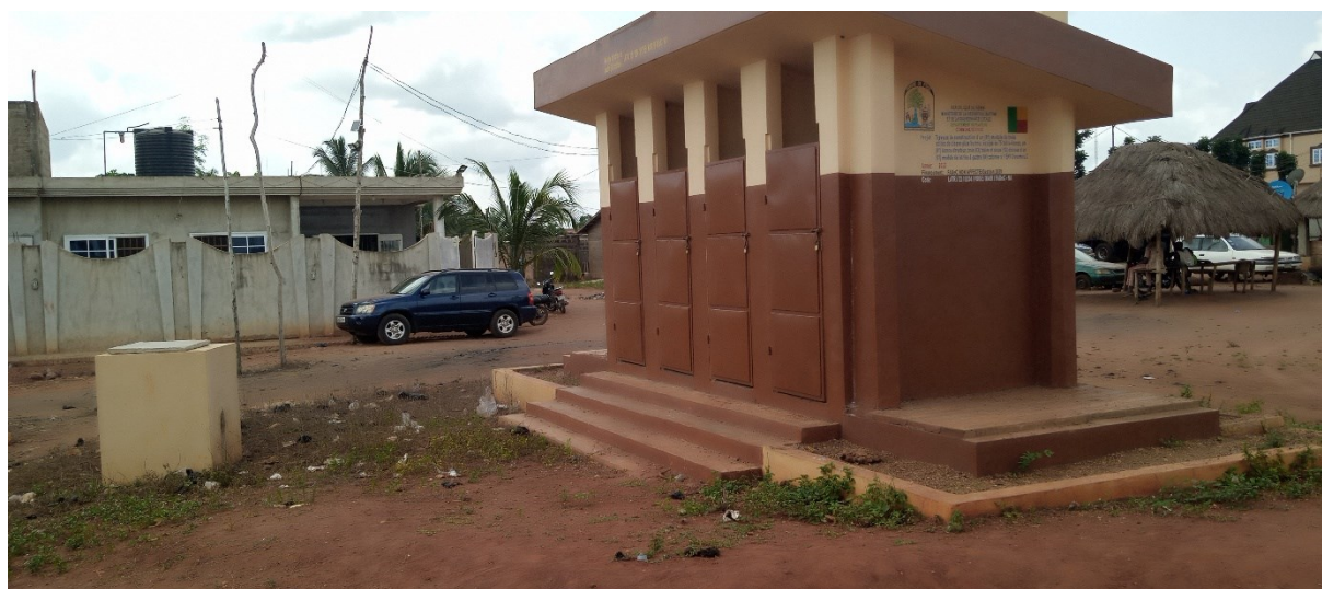
Photo 4: Module de 4 latrines construites à l'EPP Ossomou II à Pobè avec un point d'eau non fonctionnel dont les pièces sont volées.
