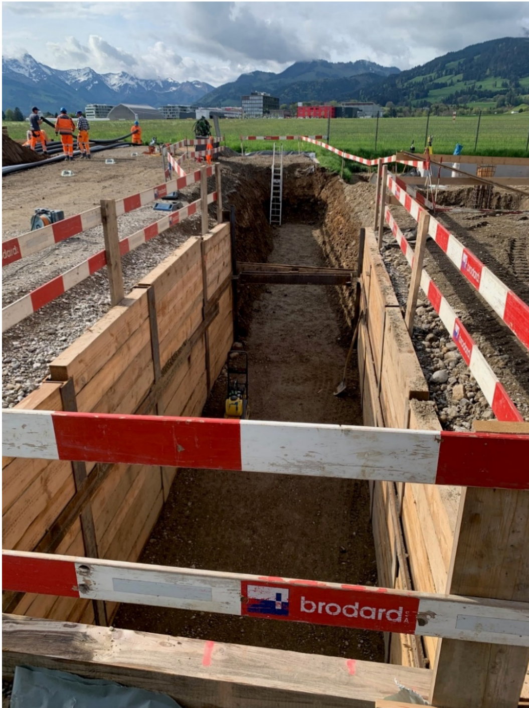
Figure 15 : Cellule de départ côté GHP
