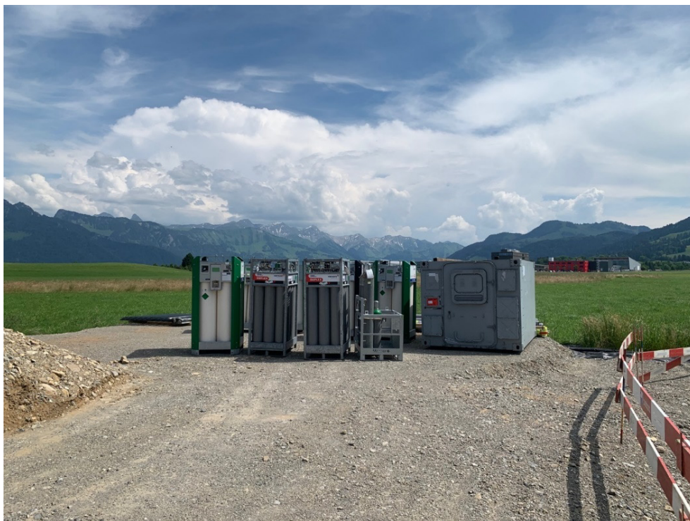
Figure 19 : Place de stockage pour le gaz de soudure
