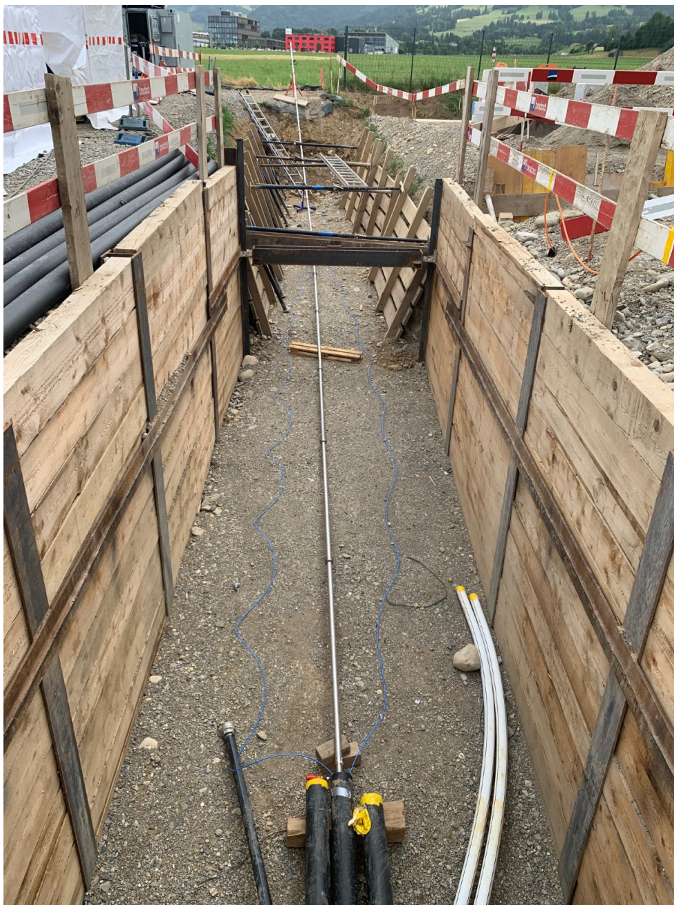
Figure 22 : Moment de l'introduction de la conduite d'hydrogène haute pression sur laquelle il faut appliquer le minimum de courbure
