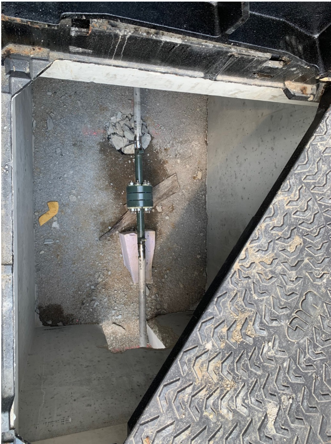
Figure 27 : Installation de séparation galvanique de la conduite hydrogène dans une des chambres
