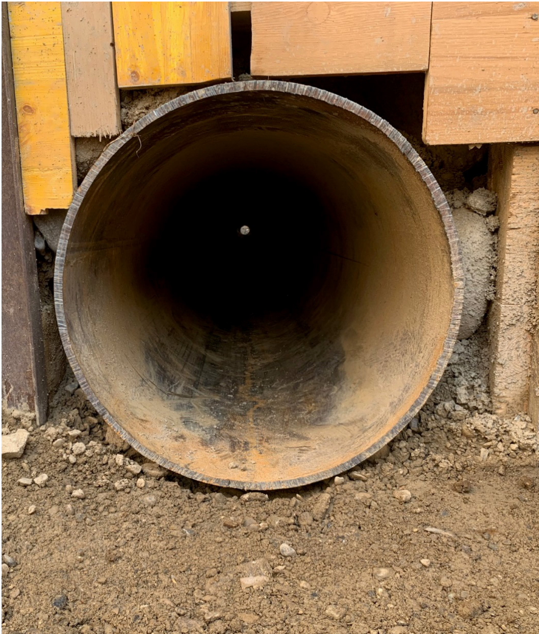
Figure 18 : Fourreau en acier qui contient l'ensemble des tuyaux ; on voit la rectiligne en apercevant la lumière de l'autre côté
