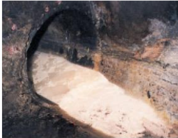
Abb. 23 Quelle: Tunnel Belchen, Ablagerungsbildung (Einflüsse des Bergwassers, M.C. Wegmüller)
