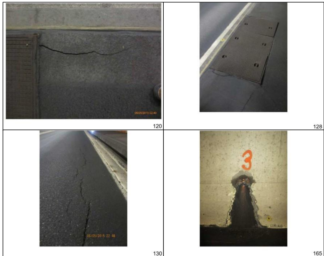
Abb. 21 Befundaufnahme Hauptinspektion 2015 N28 Gotschnatunnel (Ausschnitt Fotodokumentation)
