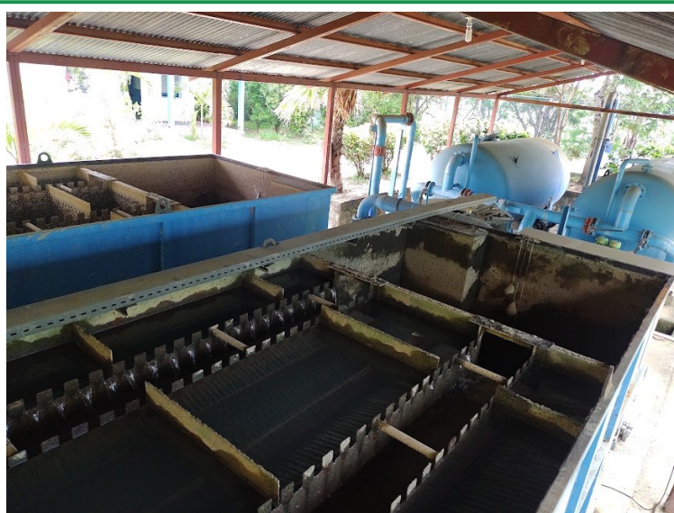
Planta potabilizadora de la ciudad de Ocotal (módulo parcialmente disfuncional).
