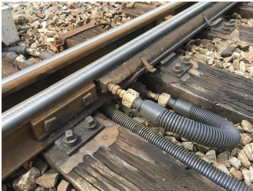
Abbildung 6: Wärmetauscher an der Zungenschiene mit Rücklaufleitungen zur Wärmepumpe.
