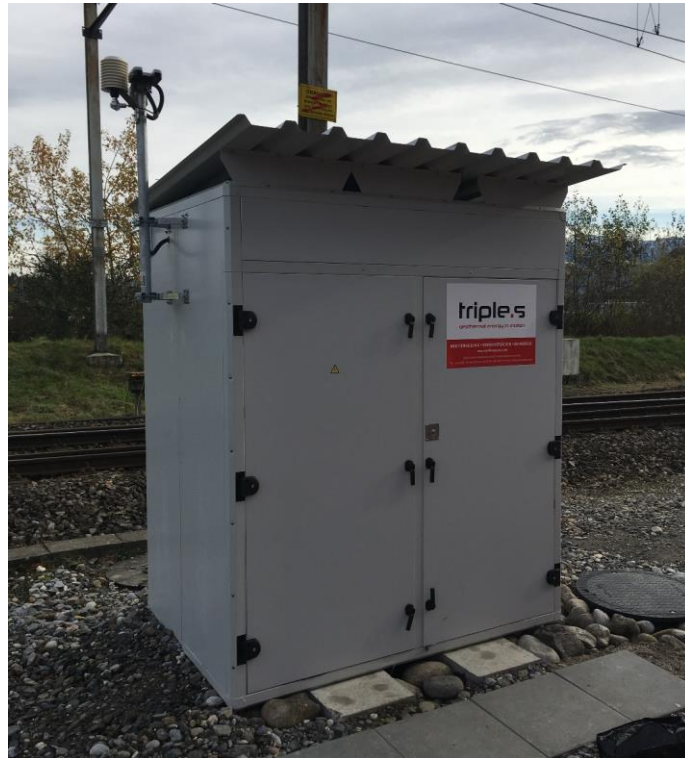
Abbildung 4: Systemschrunk mit Wetterstation.
