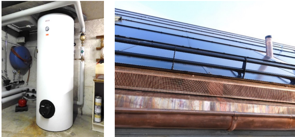
Abbildung 10: Warmwasser-Speicher im Keller (links), Wärmepumpen-Luftansauggitter über der Regenrinne im Solardach (rechts).
