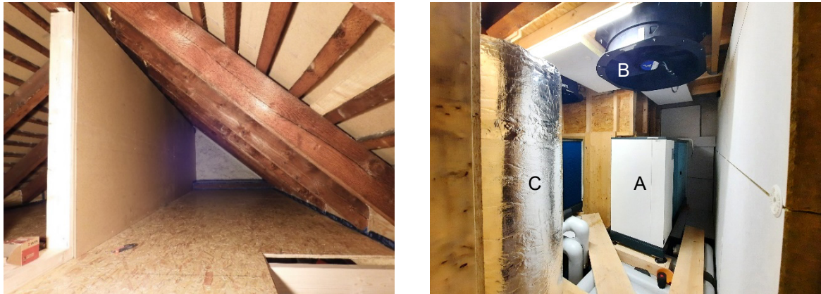
Abbildung 9: Begehbare Luftansaugkanäle unter Dachgiebel (links), Technikraum mit einer der Wärmepumpen (A), einem der Axialventilatoren (B) und dem gedämmten und beheizbaren Ausdehnungsgefäss (C) (rechts).
