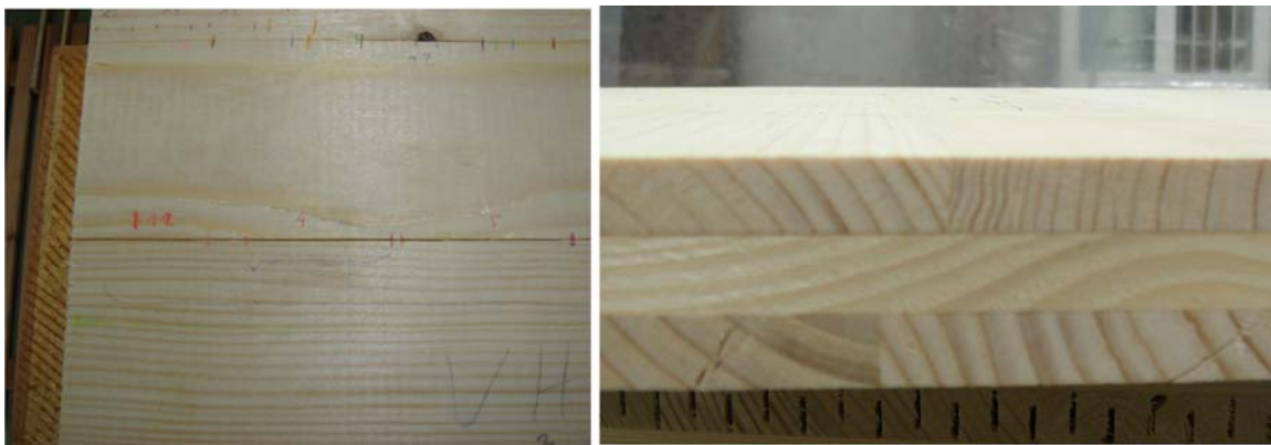
Abbildung 10: Rissbildung in den Decklagen bei der Variante VHS (links Risse zwischen den Lamellen, rechts: Risse innerhalb Lamellen)
