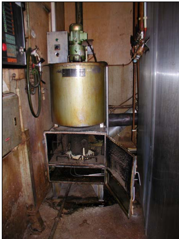
Abbildung 1: Raucherzeugung für das Räuchern von Fleischprodukten bei der Firma Bigler AG
