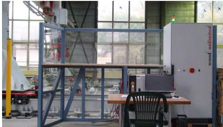
Figure 7 : Pupitre de commande de l'installation
