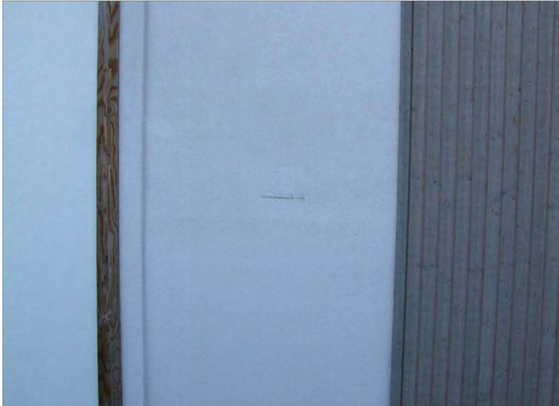
Abb. A-2: Stand des Aussenputzes der Dämmsteinkonstruktion nach einem Jahr; Frontansicht (oben), Detail mit Temperatursensor PT100 an der Aussenoberfläche (unten)
