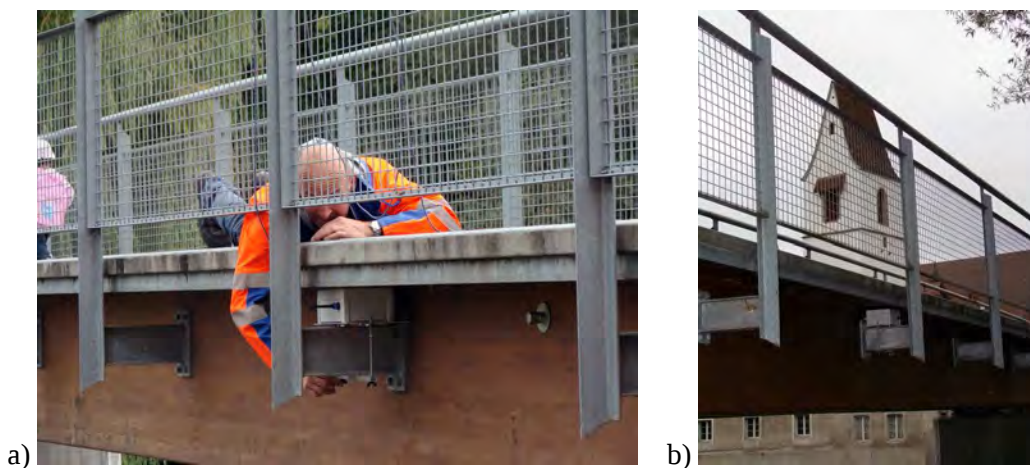
Abbildung 5.2: a) Montage eines Sensorknotens. b) Sensorknoten an der Stelle N2.
