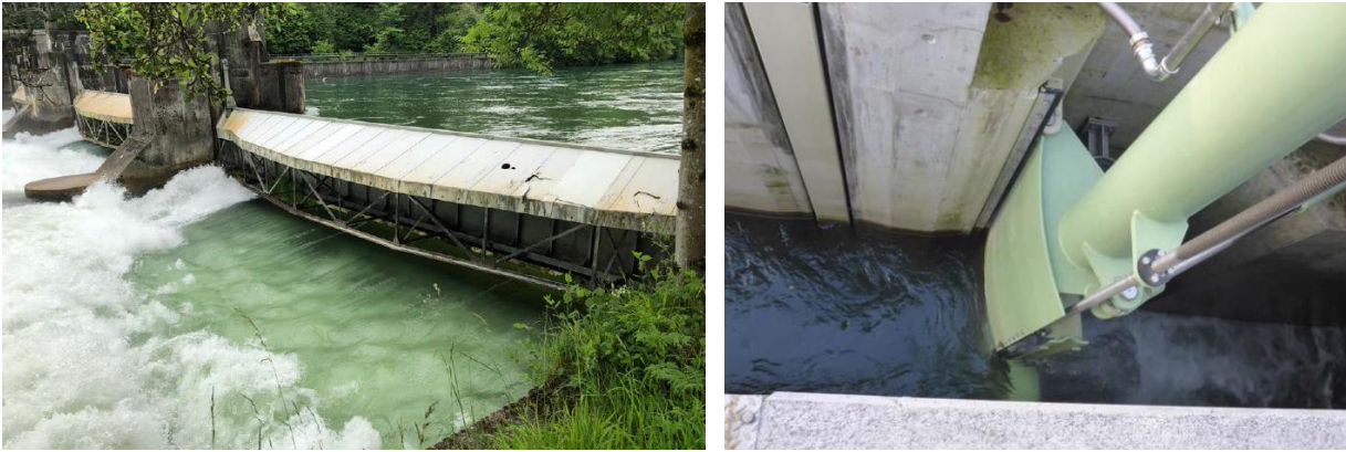
Figure 2 : Exemples de technologie de transfert des poissons à l'aval d'un barrage. A gauche, Vanne de barrage à sous-verse (centrale hydraulique de Rathausen sur la Reuss, canton de Lucerne). A droite, zone d'entrée d'un by-pass avec une porte busquée (centrale de Rüchlig sur l'Aar, canton d'Argovie). Sources : Dönni W.
