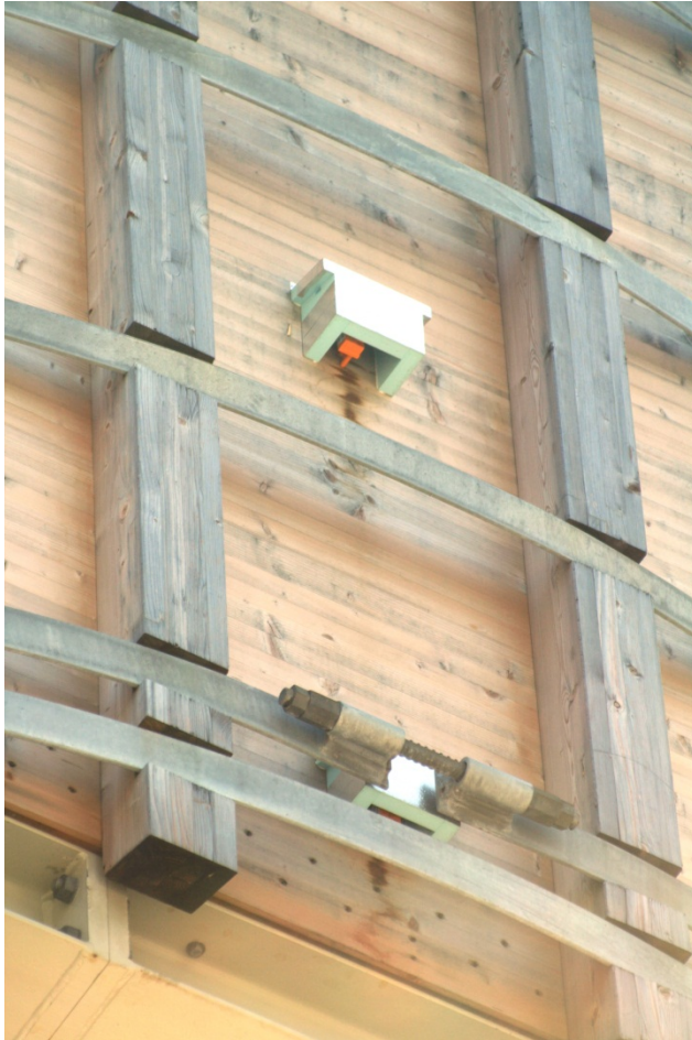
Abbildung 4.1.1: Salzsilo Urdorf mit Sensoren für eine kontinuierliche Messung der Holzfeuchte
