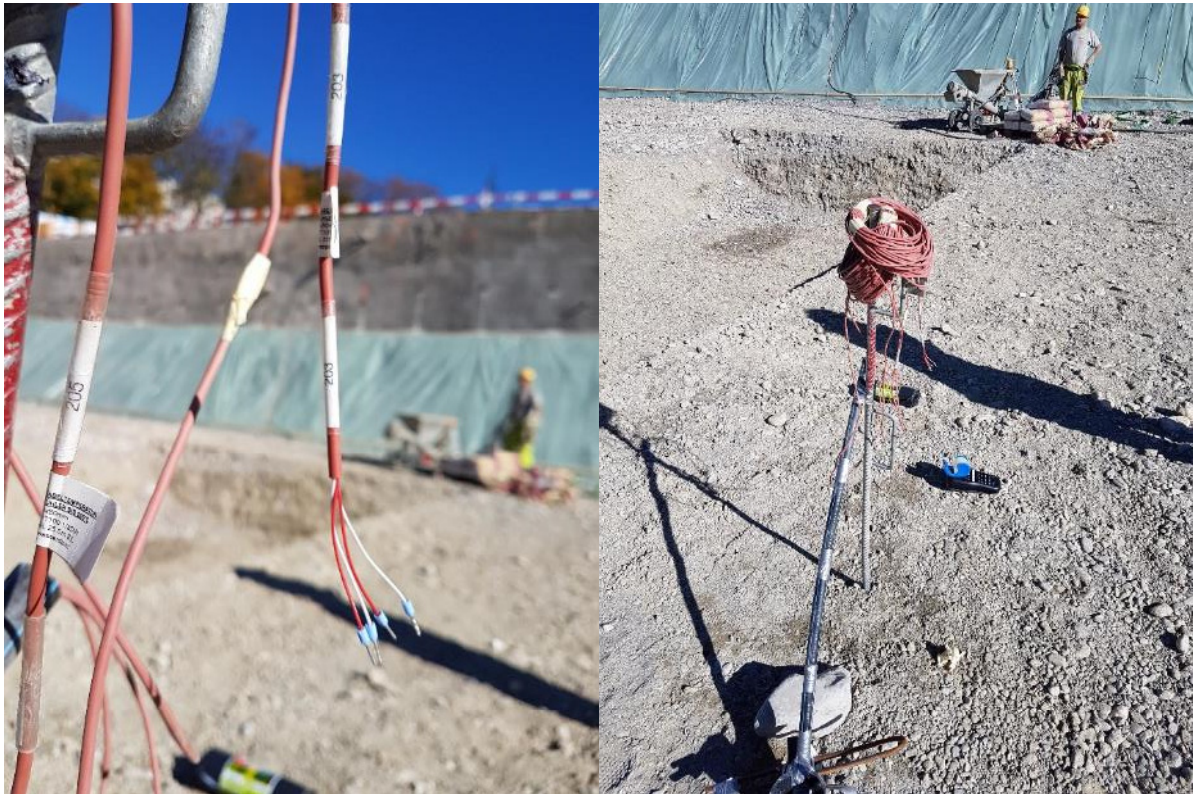
Abb. 2 Temperaturfühler unter der Bodenplatte
