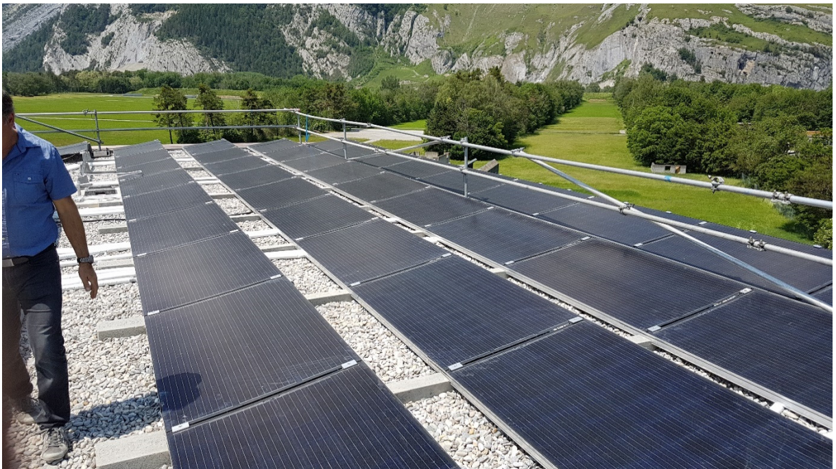
Abb. 9 Fertig installierte PVT-Module
