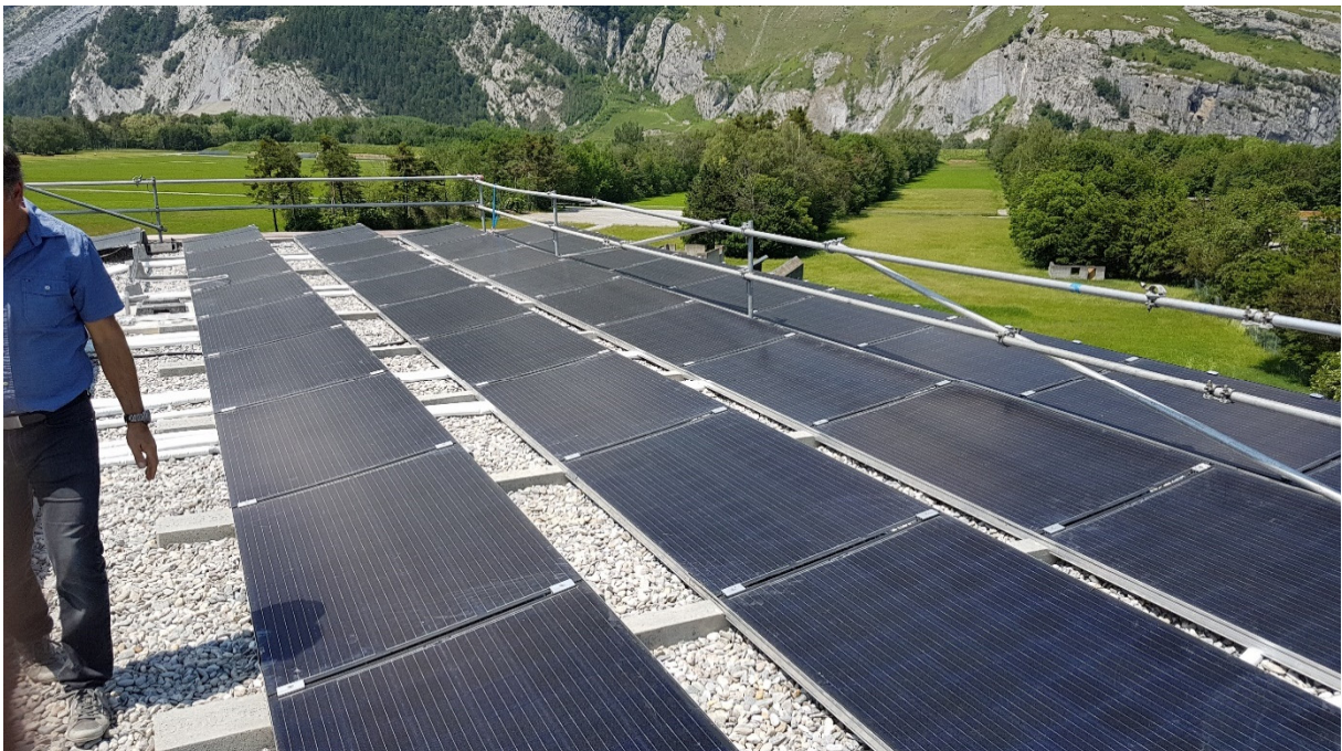
Abbildung 6: Fertig installierte PVT-Module.
