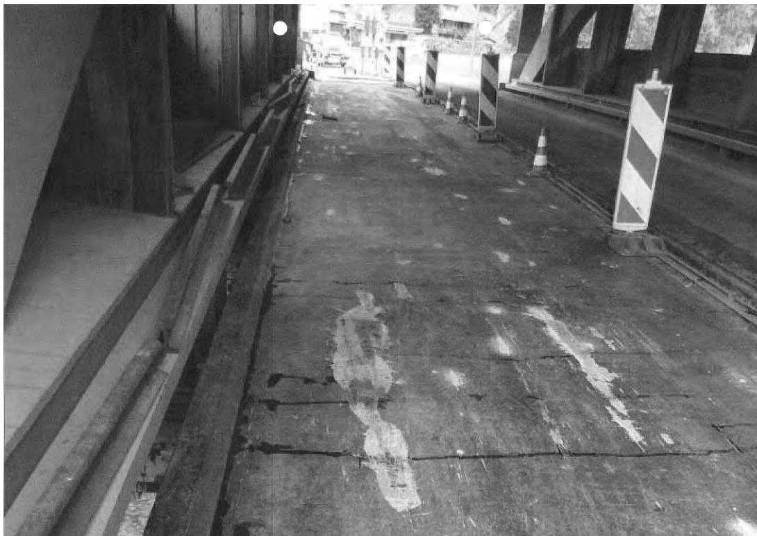
Abbildung 6: Fahrbahnplatte mit beschädigter Abdichtung nach Entfernung des Asphaltbelags (Bildquelle: Kt. Tiefbauamt Bern)
