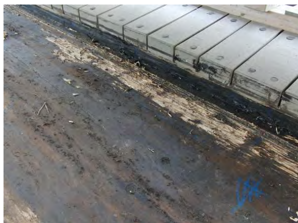
Abbildung 10: Mechanische Beschädigung an Fahrbahnoberseite
