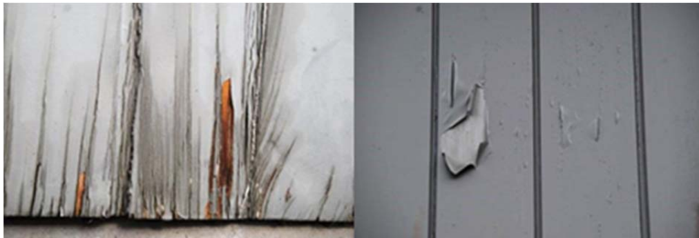
Abbildung 1.2: Schadensfälle an vertikalen Fassadenschalungen
