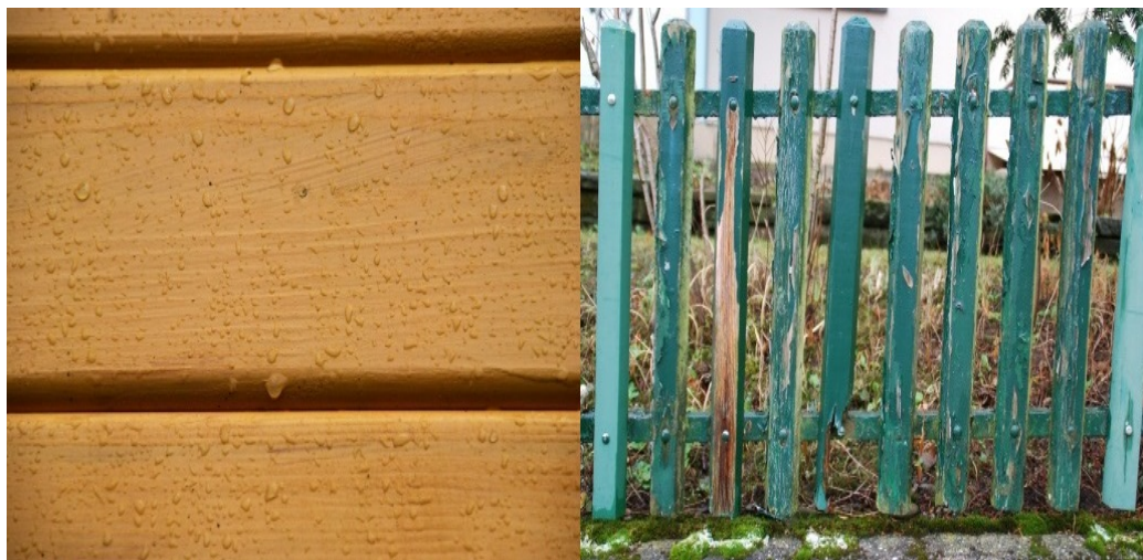
Abbildung 2.12: V.l.n.r. Wasser auf einer Fassadenschalung, Nadelholzzaun mit starkem Holzabbau
