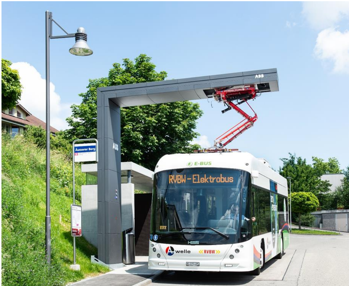
Abb. 63: Ladestation Äusserer Berg
