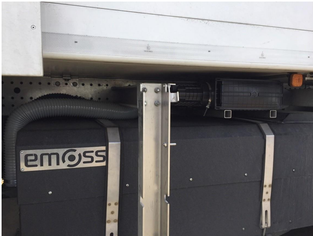
Abbildung 60: Einbau einer Luftkühlung für die beiden 60 kWh Batteriemodule im Fahrzeug
