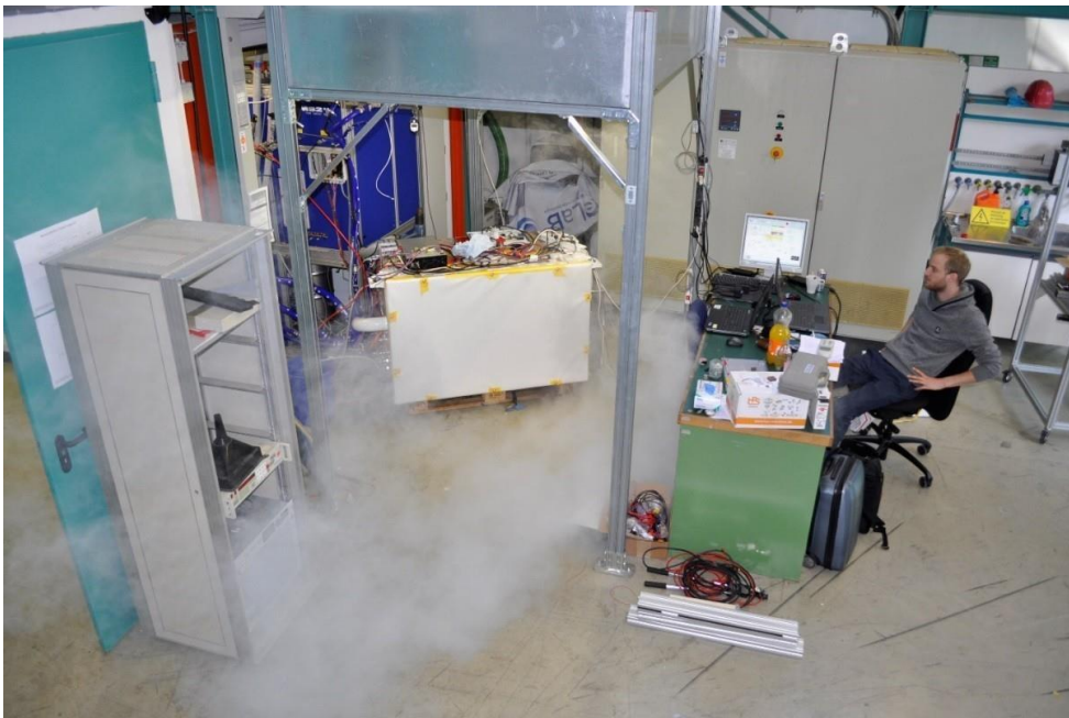
Abbildung 38: Inbetriebnahme des im Gehäuse eingebauten Systems am ZSW in Ulm
