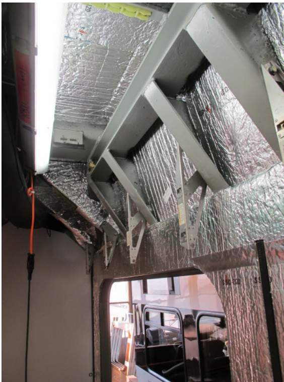
Abbildung 33. Aufwändige Wärmedämmung ohne vorgefertigte Zuschnitte bei den Abstützungen des Haupttransformators an der Decke des Endwagens ET1. Foto: ECOTRANS Peter Wüst, 13.10.2017.
