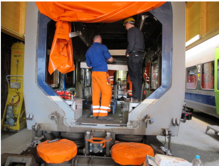
Abbildung 57. Endwagen ET2 mit abgesenktem Decken-Lüftungskanal. Der Decken-Lüftungskanal des gesamten Niederflurabteils wird bis zur Lüftungsgruppe an einem Stück abgesenkt. Foto: ECOTRANS Peter Wüst, 12.10.2017.
