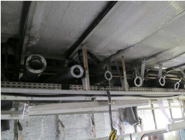
Abbildung 59. Anschlussrohre für Ausblasöffnungen im Bodenbereich nach Demontage des Decken-Lüftungskanals. Foto: ECOTRANS Peter Wüst, 13.10.2017.
