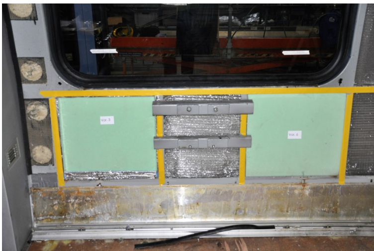
Abbildung 20. Wärmedämmung Variante 6 (rechts) als partieller Vorversuch an der rechten Seitenwand des Mittelwagens B vom Triebzug RABe 525 NINA 003. Ansicht noch ohne durchgehende Deckschicht Q20 6 mm. Foto: ECOTRANS Peter Wüst 12.01.2017.
