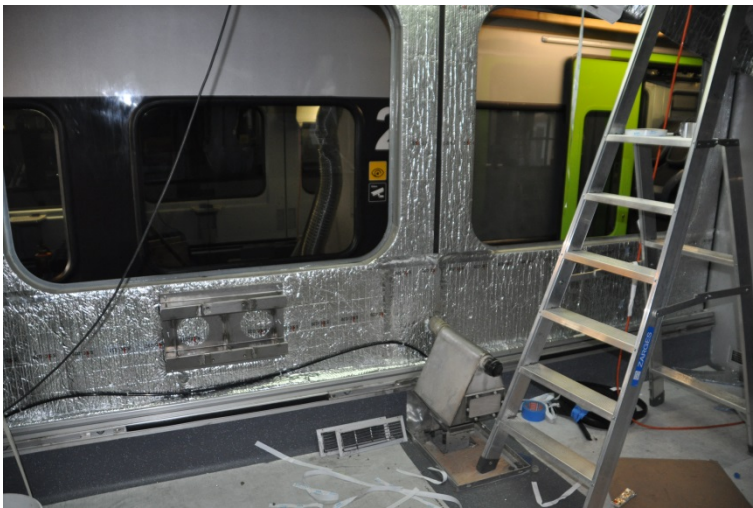
Abbildung 83. Seitenwand im Hochflurabteil des Endwagens ET1, mit neuer Halterung für Seitenwandtische unterhalb des Fensters, montiert mit thermischer Entkopplung auf die Seitenwandprofile. Foto: Renato Gartner, 14.11.2017.
